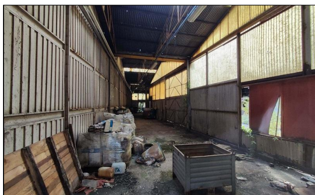
Vista interna immobile E – con rifiuti abbandonati
