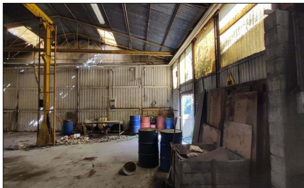
Vista interna immobile E – con rifiuti abbandonati
