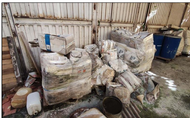
Vista interna immobile E – con rifiuti abbandonati
