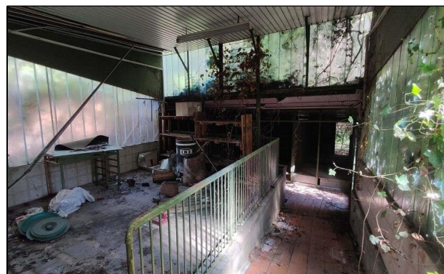
Tettoia precaria lato sud-est
