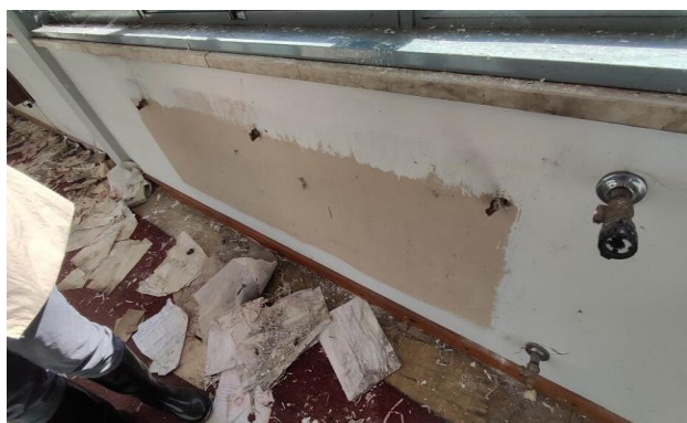
Uffici piano primo - ventilconvettori asportati
