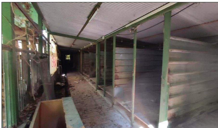
Canile lato est con strutture precarie
