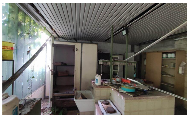
Tettoia precaria lato sud-est
