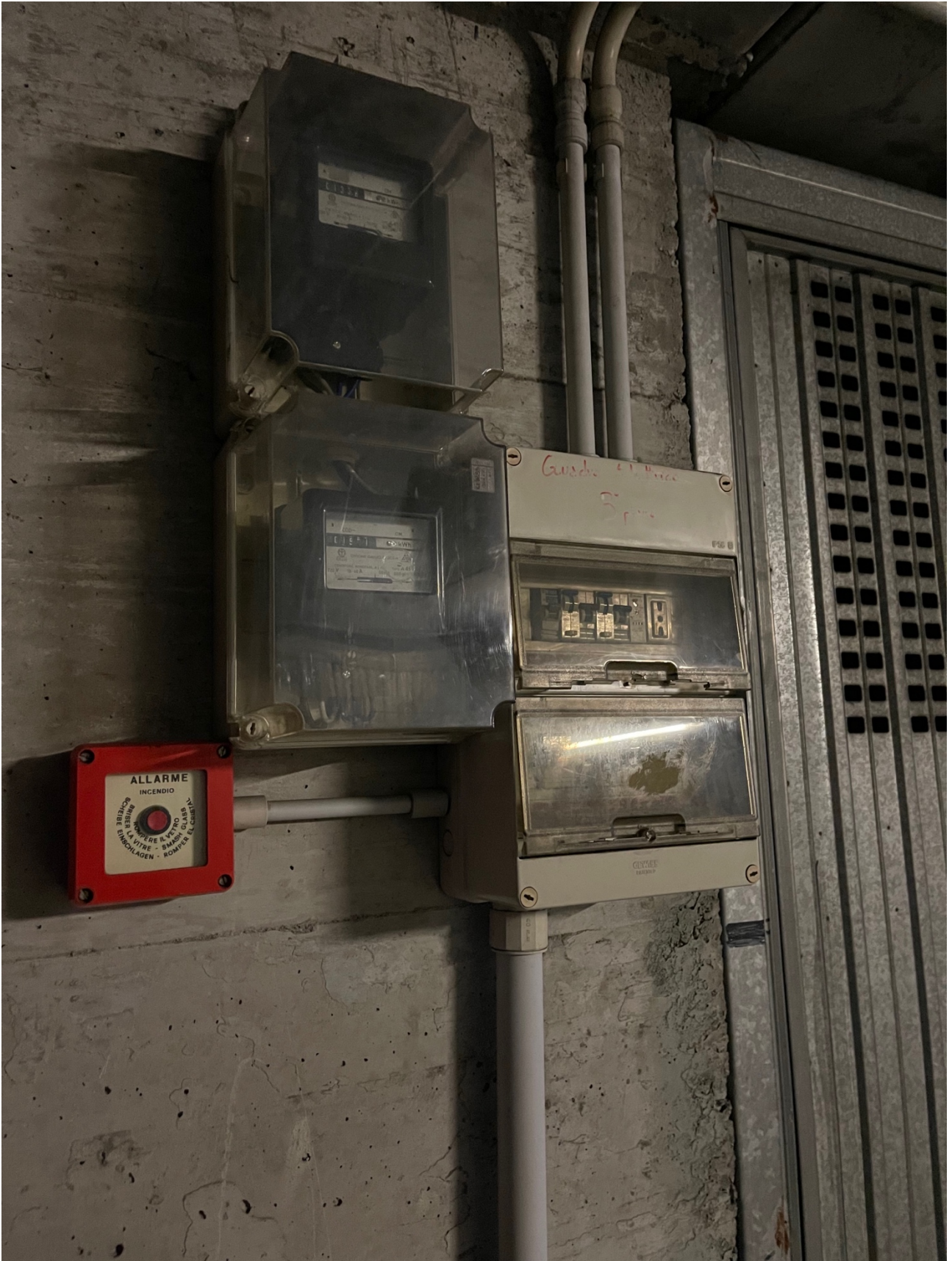
QUADRO ELETTRICO NELL'AREA COMUNE
