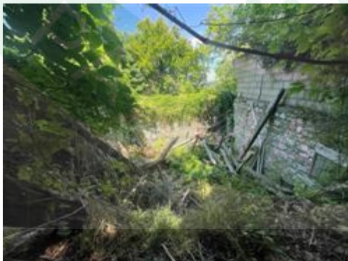
Foto - Ex deposito crollato
