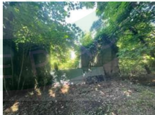
Foto - Ex deposito crollato
