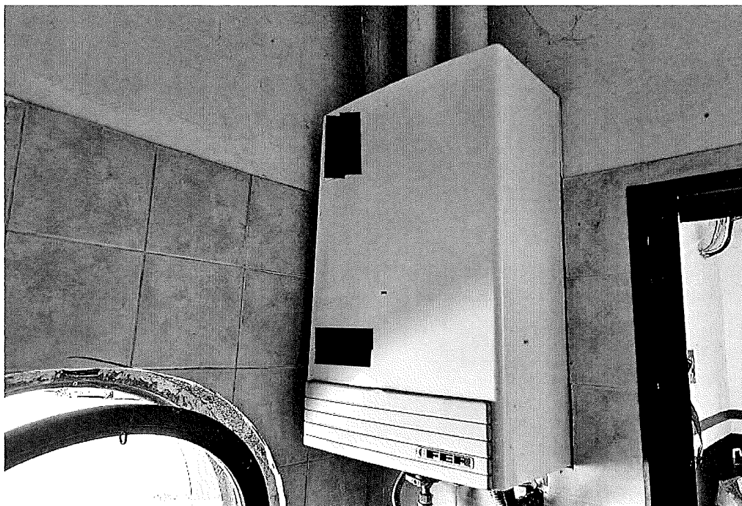
Caldia per produzione ACS e forse per riscaldamento del bagno
