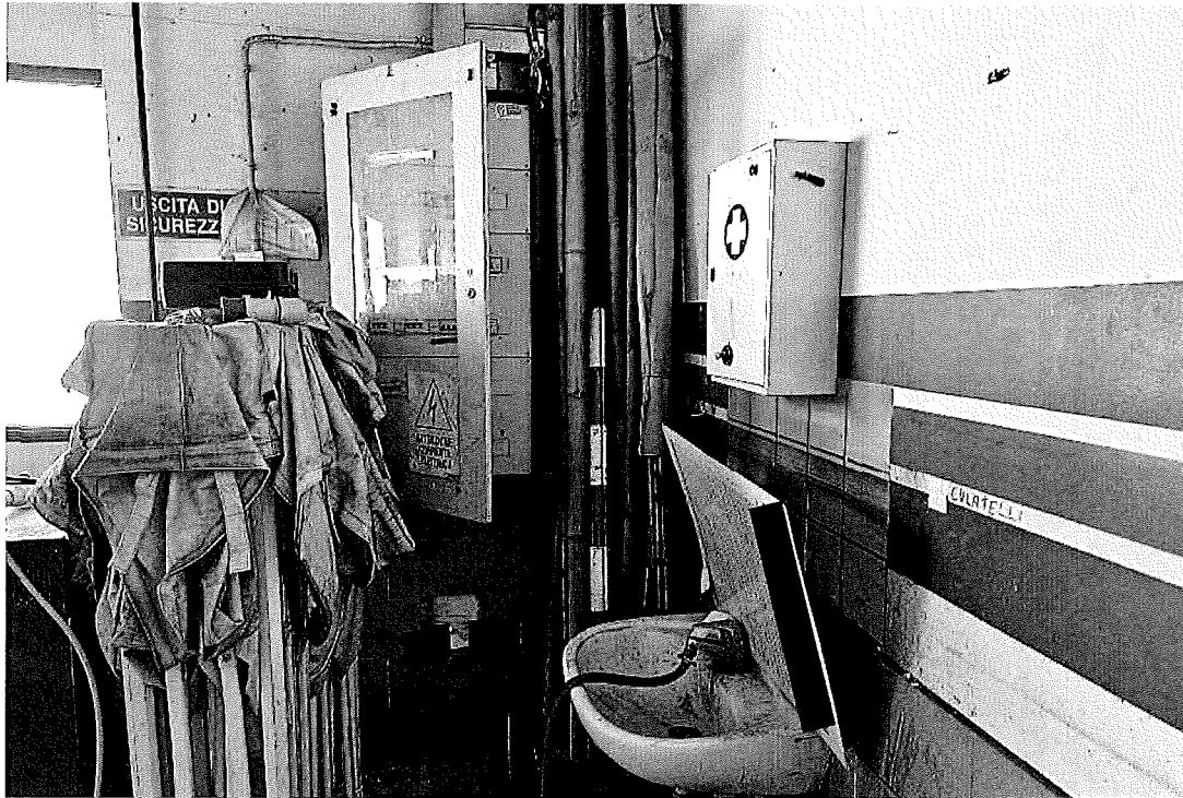
Quadro elettrico Lotto 004
