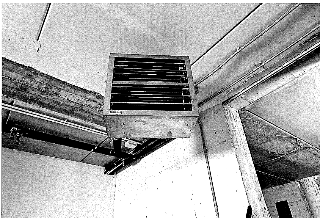
Impianto di riscaldamento ad aria
