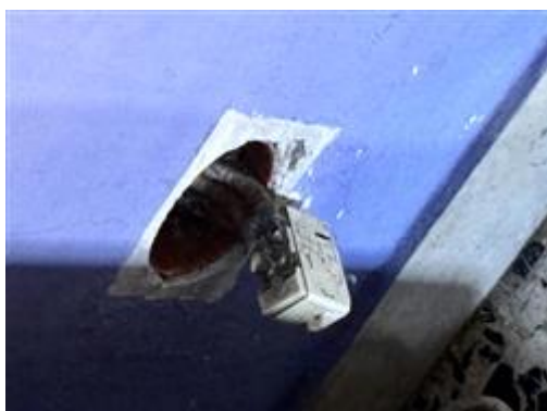
Particolare impianto elettrico
