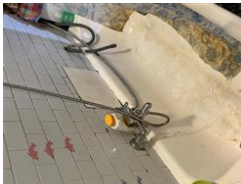
Particolare gruppo vasca - impianto idrico
