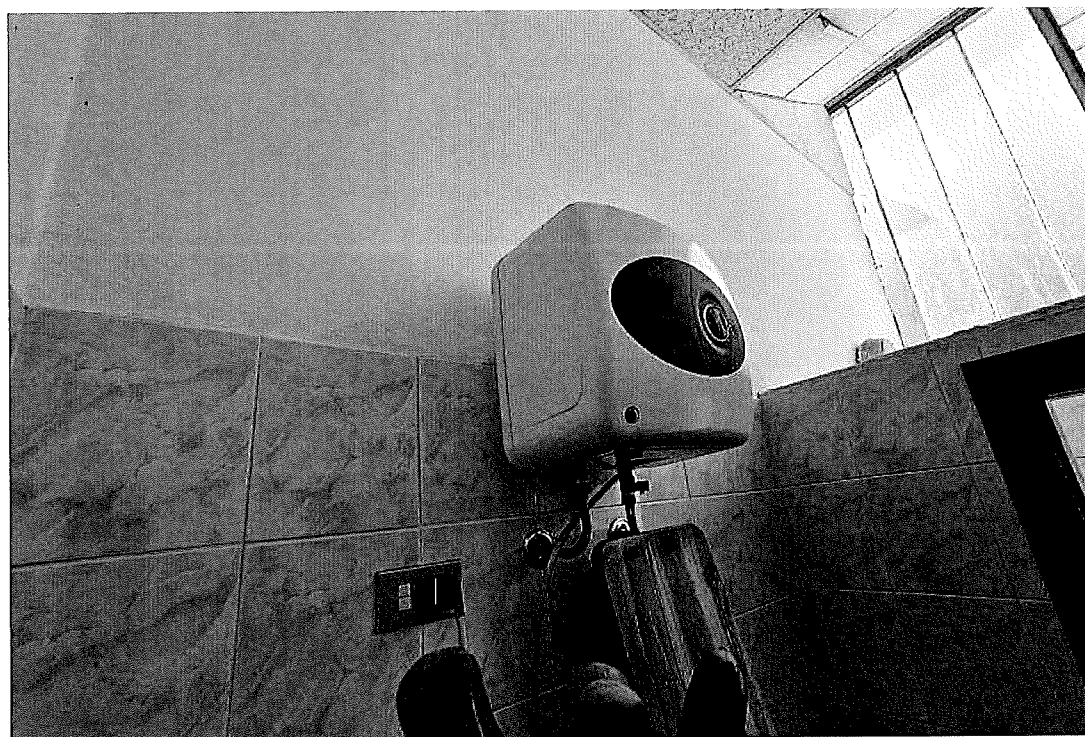
Boiler elettrico per la produzione di ACS
