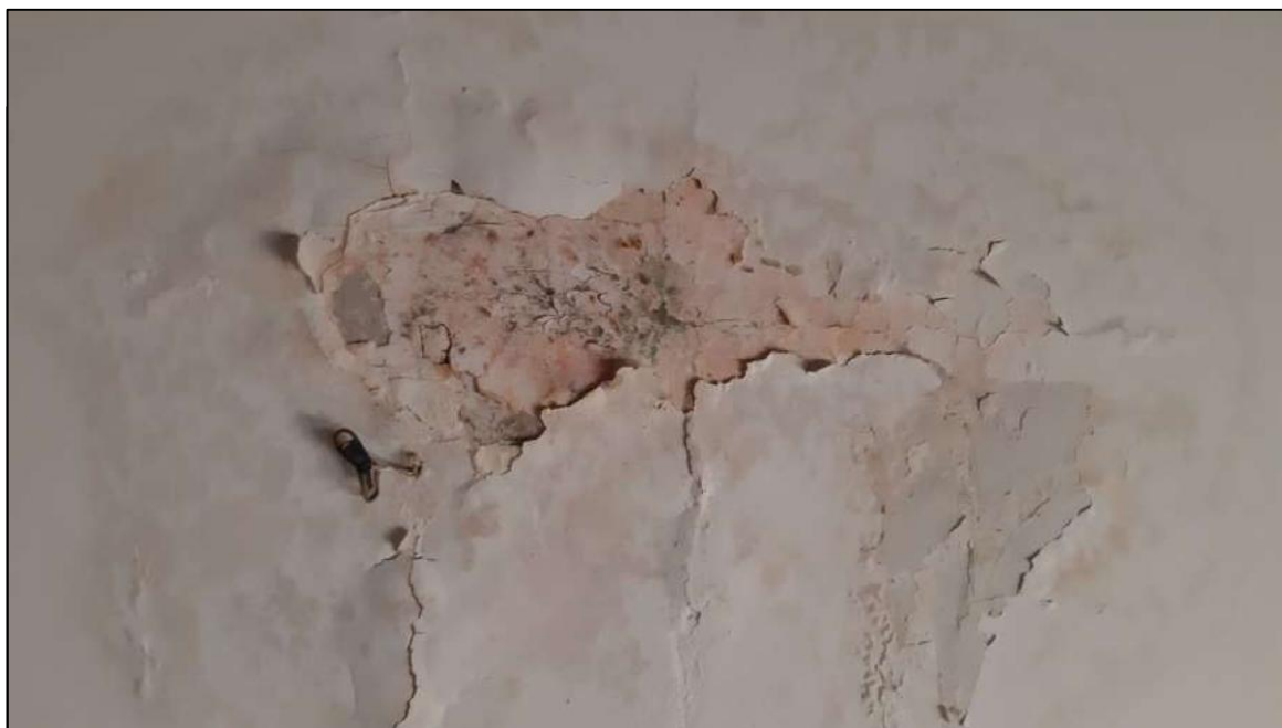
foto 24 - vista dell'infiltrazione sul soffitto del soggiorno n. 2.
