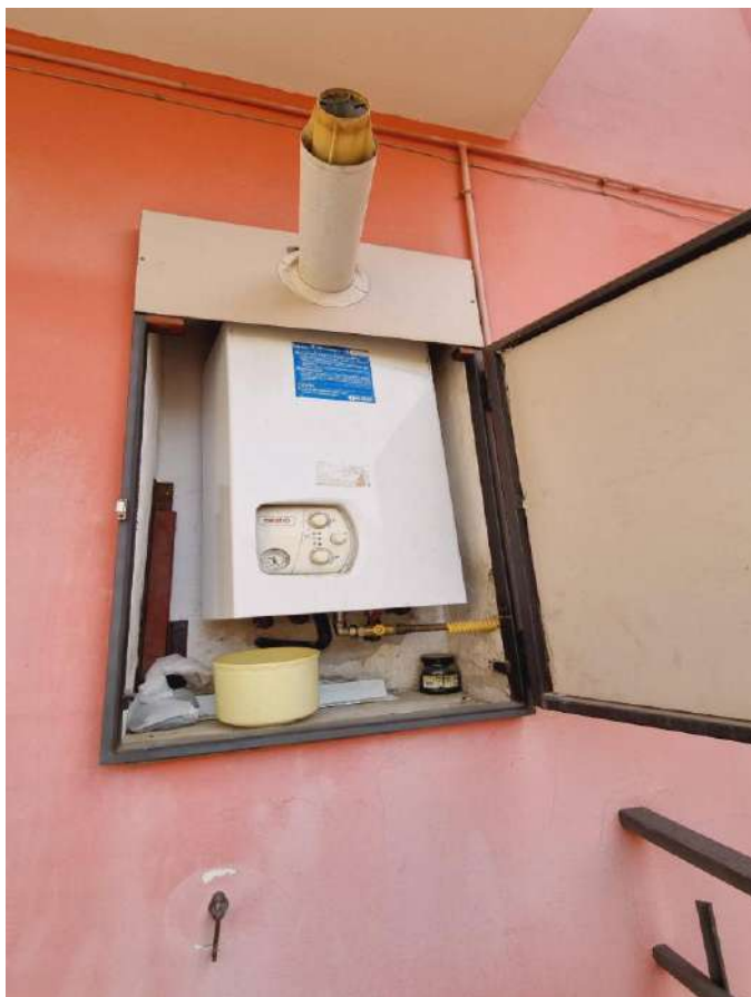
Foto balcone Prospetto Principale - caldaia
