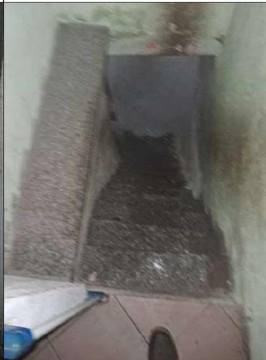
▲ Vista scala interna non a norma
