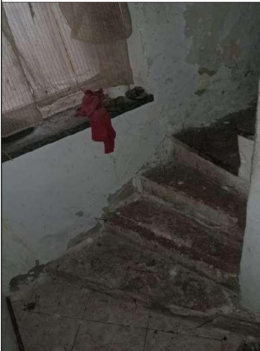
▲ Vista interna scala non a norma
