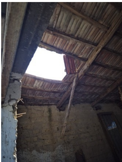
Figura 32 condizioni del tetto del box auto pertinenziale
