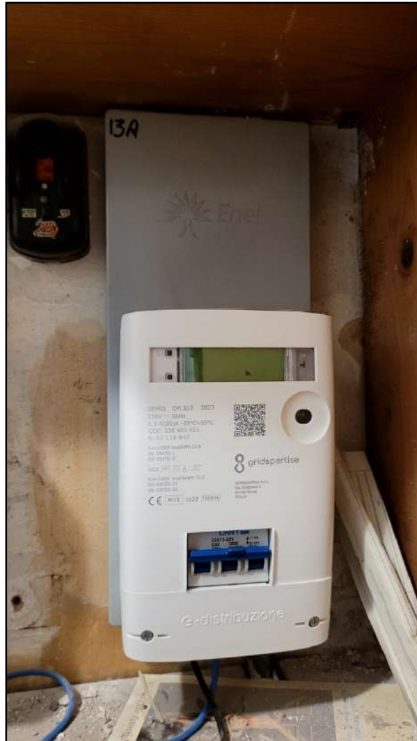
Fotografia 27 Vista contatore posto nel disimpegno comune
