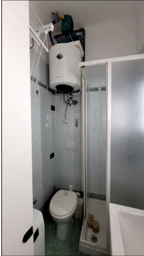
Fotografia 25 Bagno con vista autoclave e boiler acs
