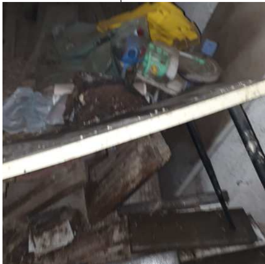
Foto n. 27 – Materiale depositato nel sottotetto sub. 138
