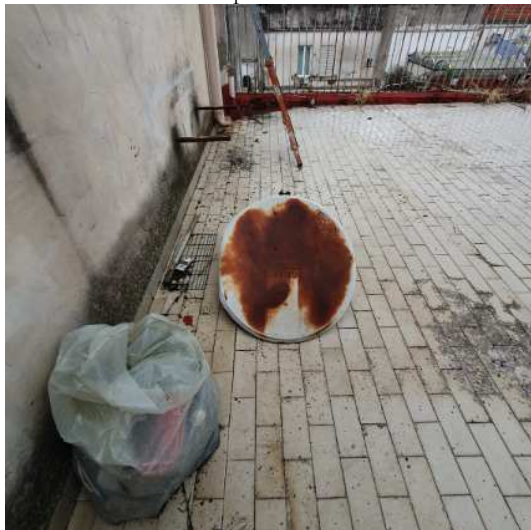
Foto n. 23 – Materiale depositato nel sottotetto sub. 137
