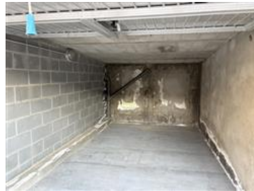
Infiltrazioni d'acqua piovana dalla copertura e dal muro di confine
