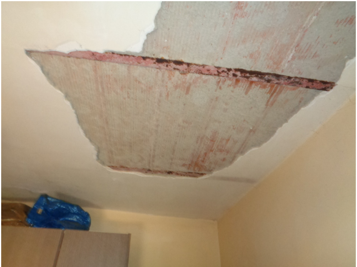
Foto n. 21: • Vistosa lacuna d'intonaco a soffitto.
