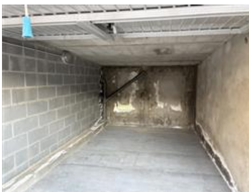
infiltrazioni d'acqua piovana dalla copertura e dal muro di confine
