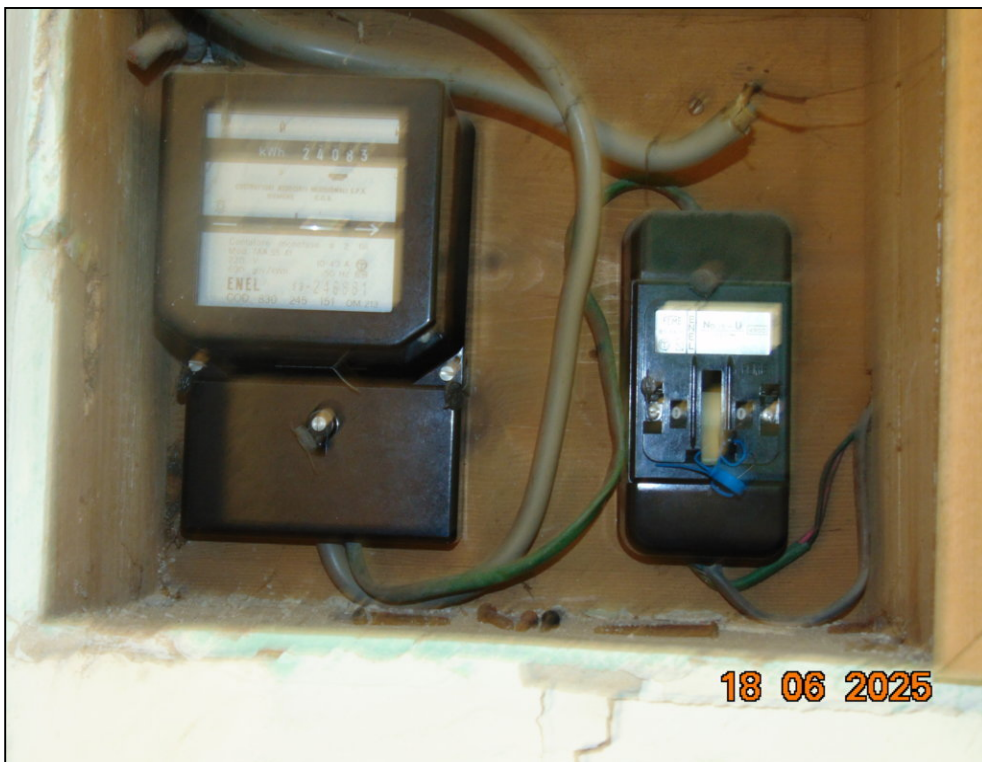
Figura 22 – Dettaglio del contatore Enel interno
