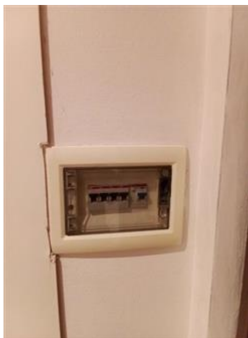
quadro elettrico interno
