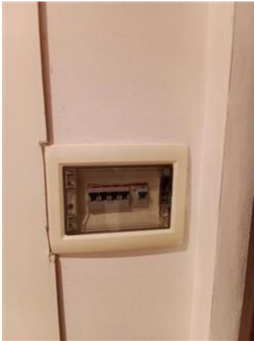
quadro elettrico interno
