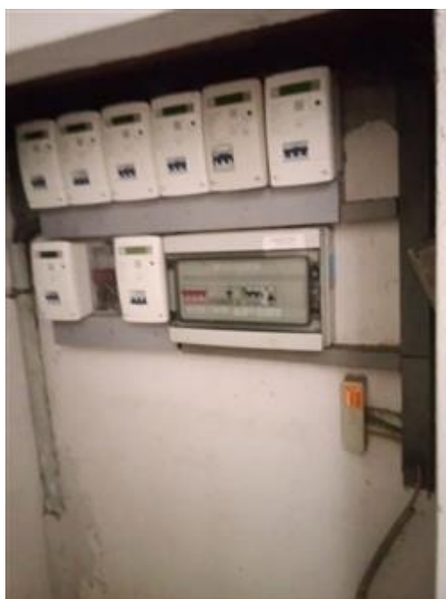
quadro contatori elettrici
