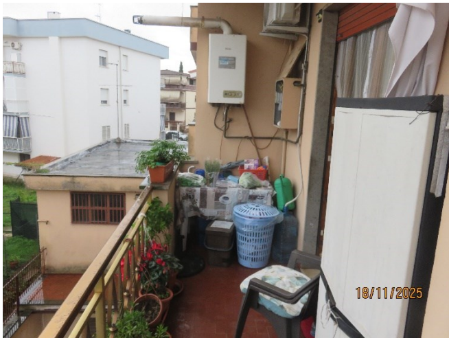
Balcone n. 2 - con caldaia
