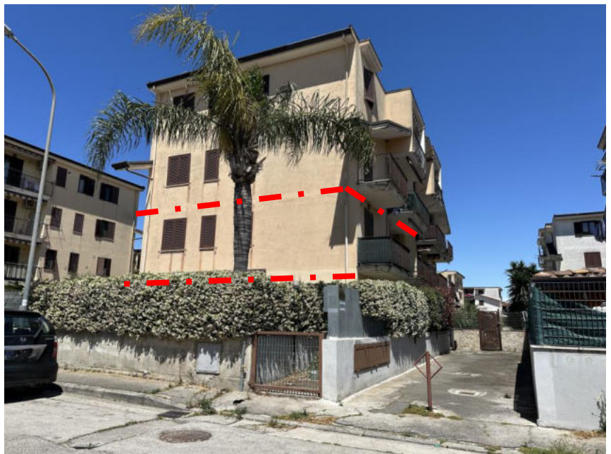
(Sotto a destra) Foto 2 – Edificio "G" di cui sono parte i beni pignorati: al Piano Primo l'appartamento.
