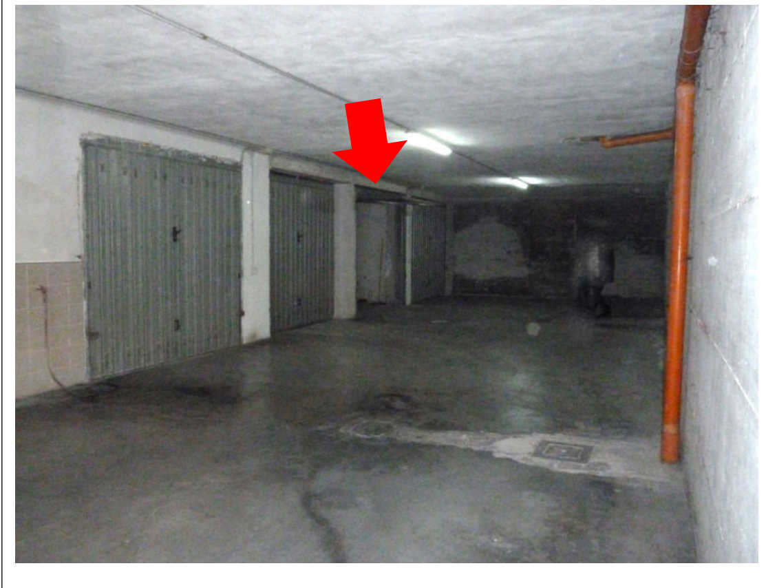
Foto 30 – Piano interrato, vista dell'area comune di manovra e dell'accesso al box auto.
