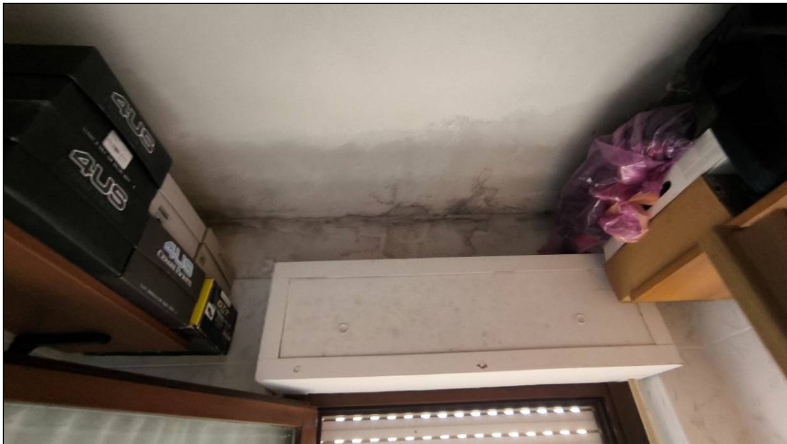
Figura 29: Vista interna del solaio del Bagno 12 al piano primo, con evidenza di umidità e muffe.
