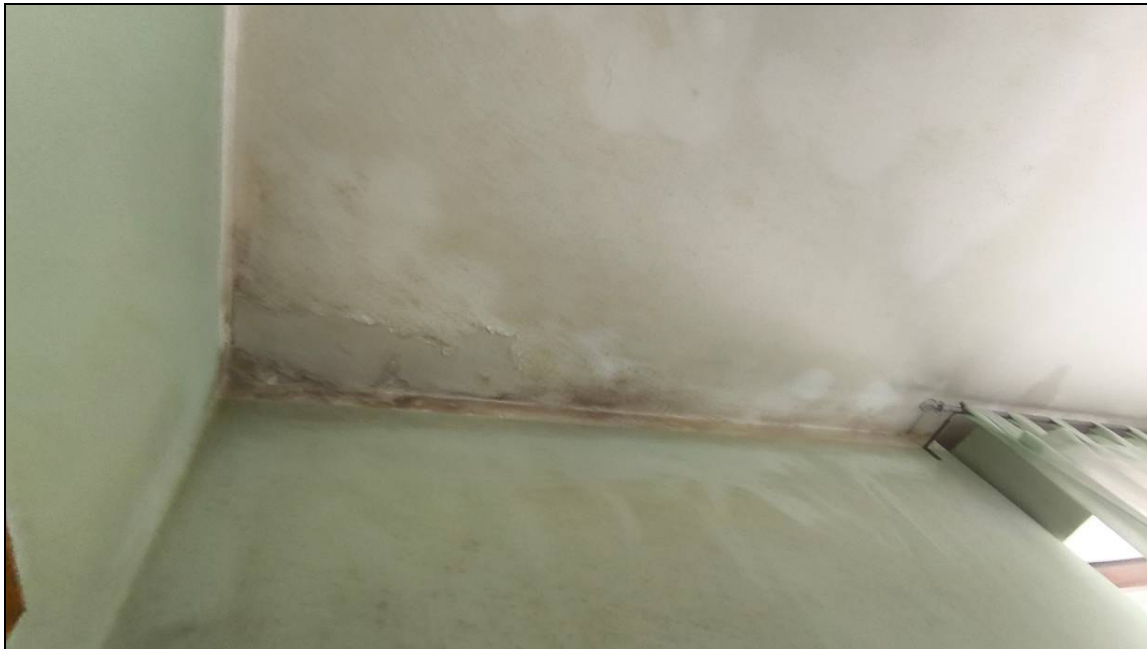
Figura 27: Vista interna del solaio della Camera 09 al piano primo, con evidenza di umidità e muffe.
