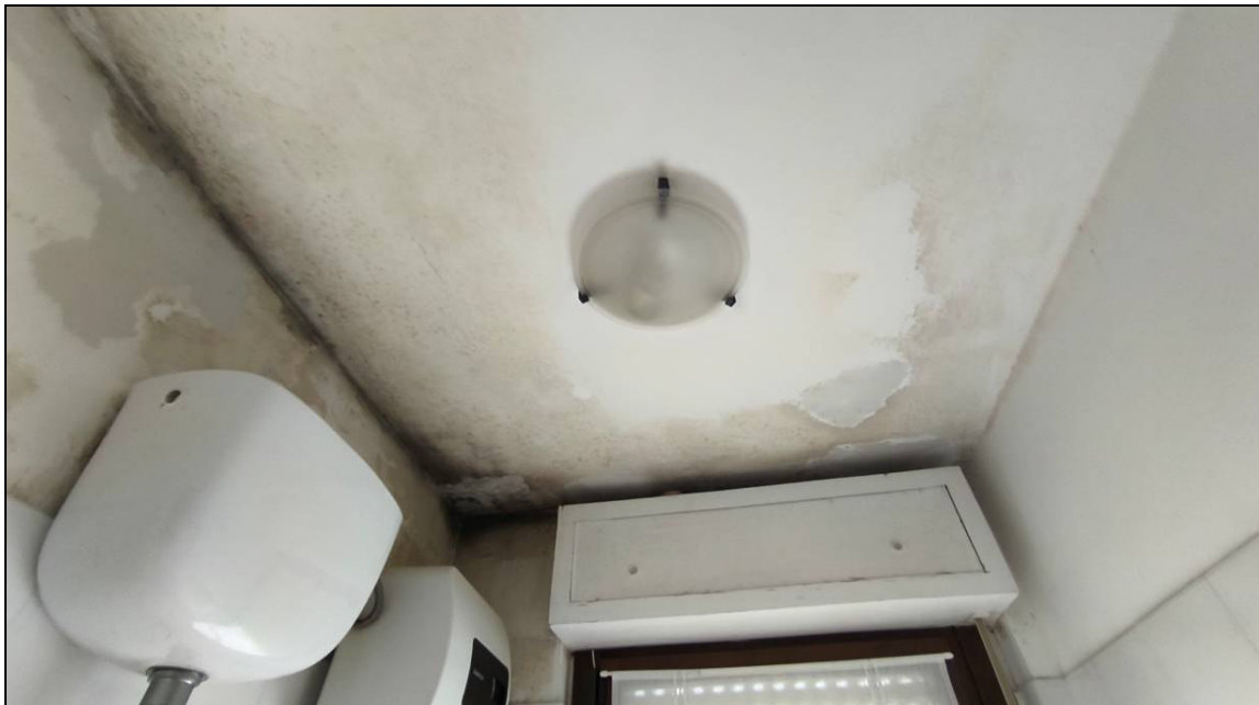
Figura 19: Vista interna del solaio del Bagno 03 al piano terra, con evidenza di umidità e muffe.
