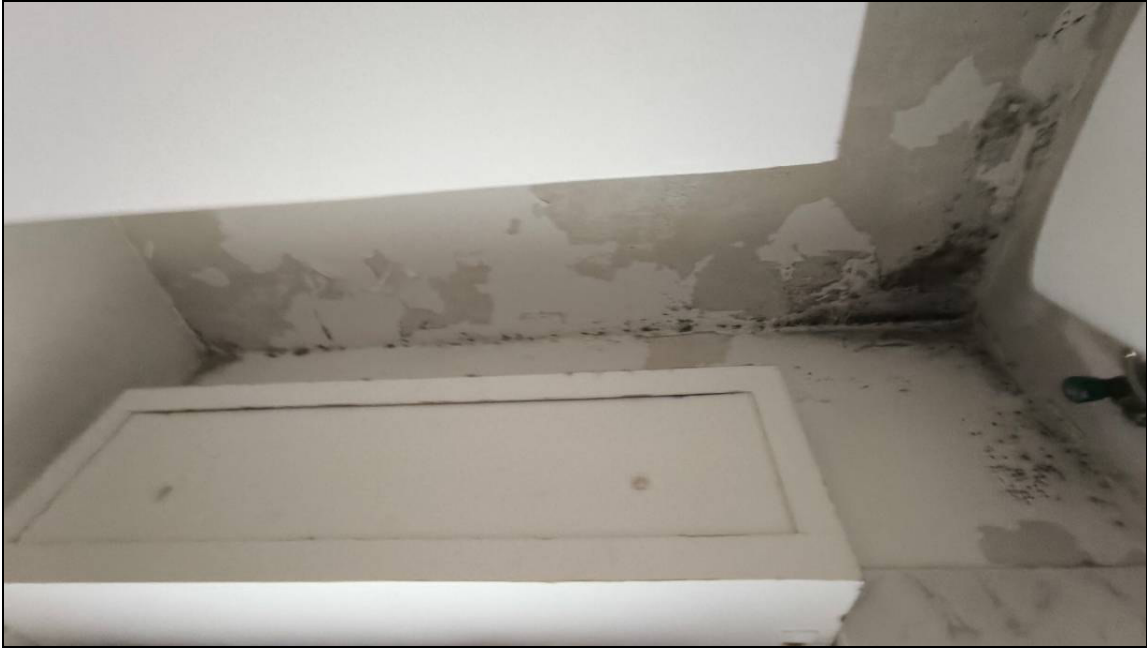
Figura 24: Vista interna del solaio del Bagno 10 al piano primo, con evidenza di umidità e muffe.
