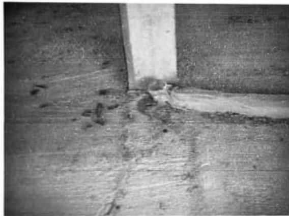
Foto n° 10 - Particolare impianto fognario al piano terra
