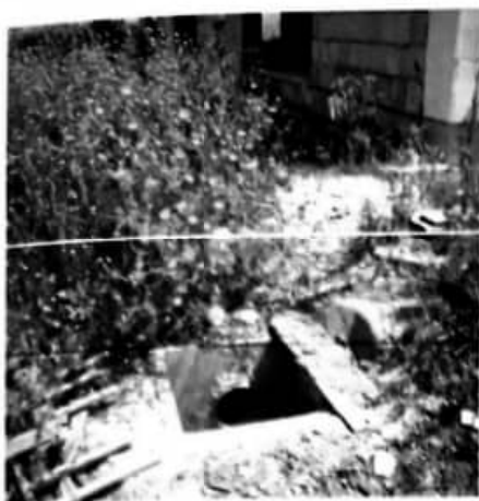
Foto n° 11 - Particolare impianto smaltimento reflui
