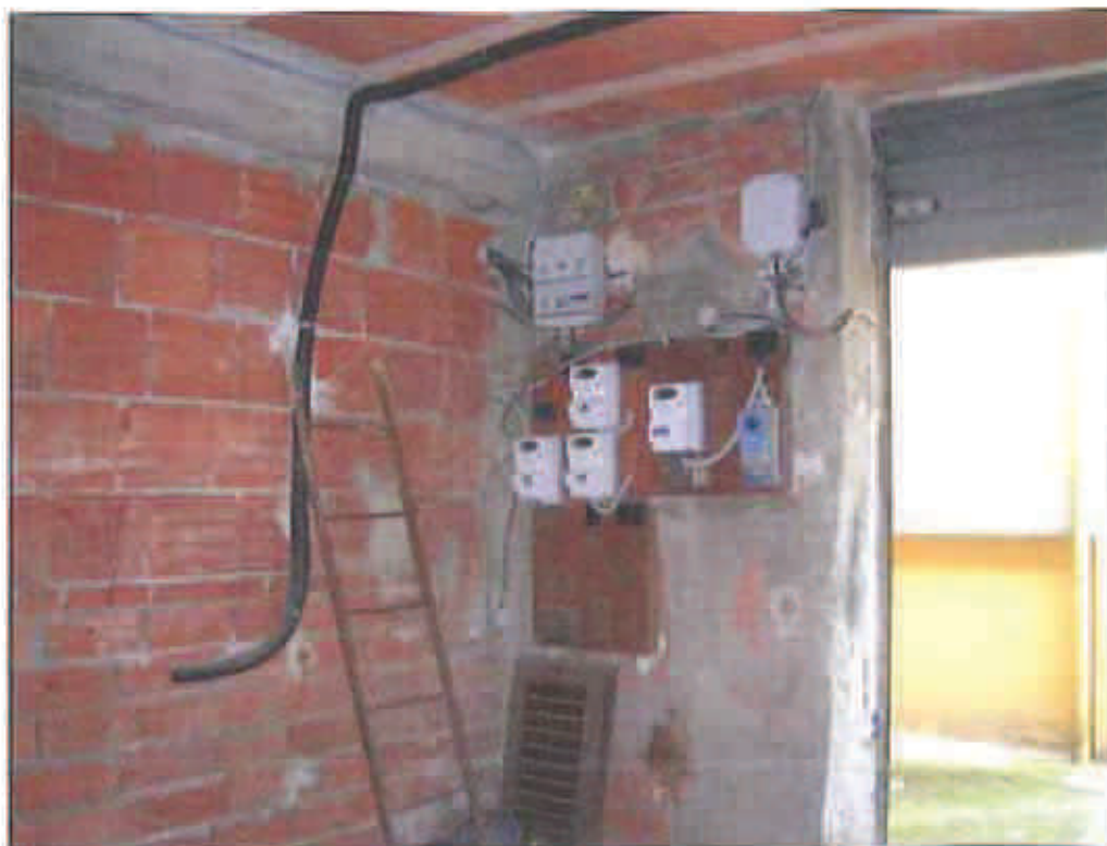
Fotografia 31: Bene 3 – Contatori della luce nel garage
