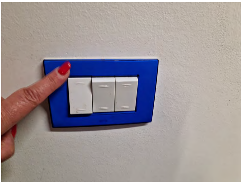
Foto 18 – Particolare impianto elettrico LOTTO 4
