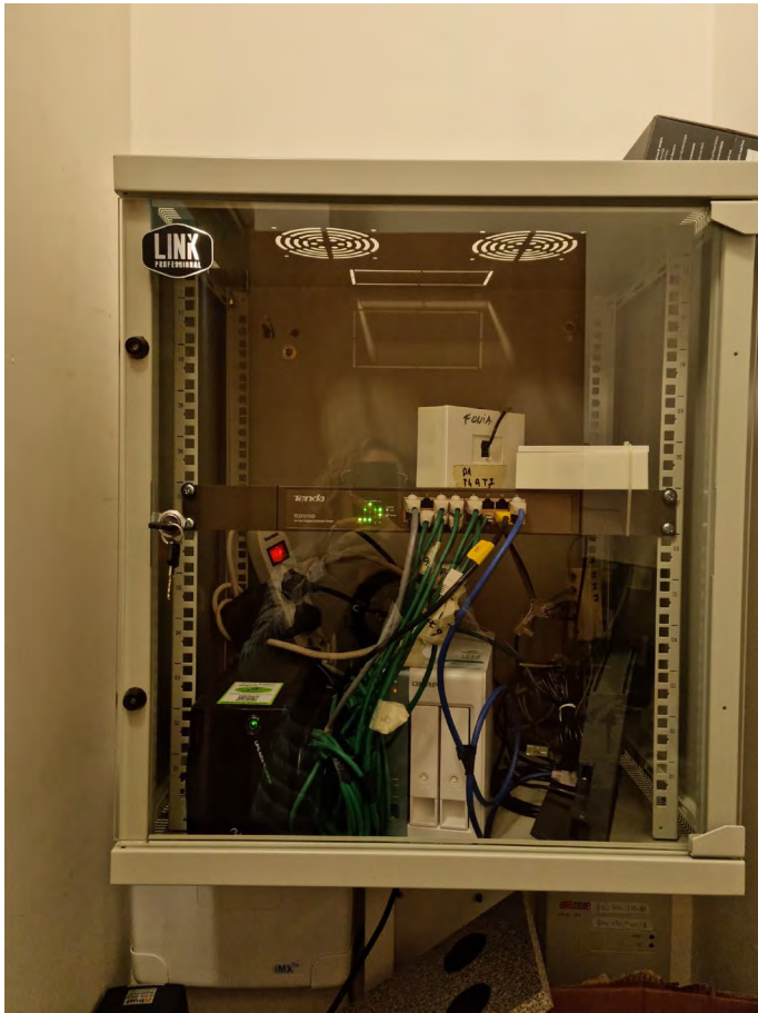
Foto 25 – Particolare centralina elettrica LOTTO 5
