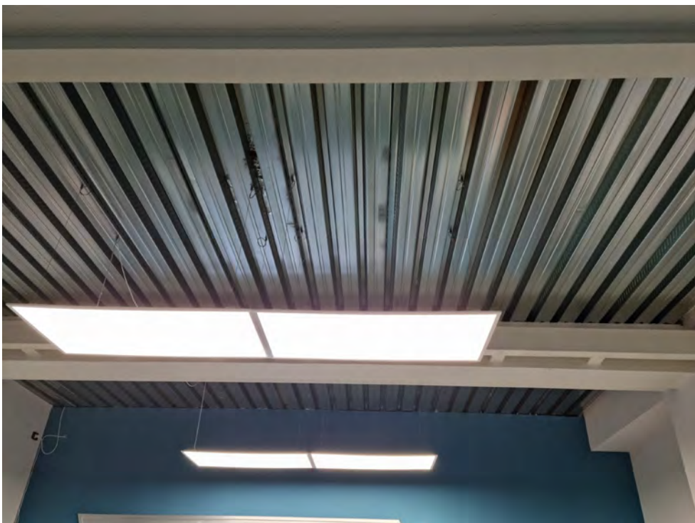
Foto 27 – Particolare illuminazione LOTTO 5
