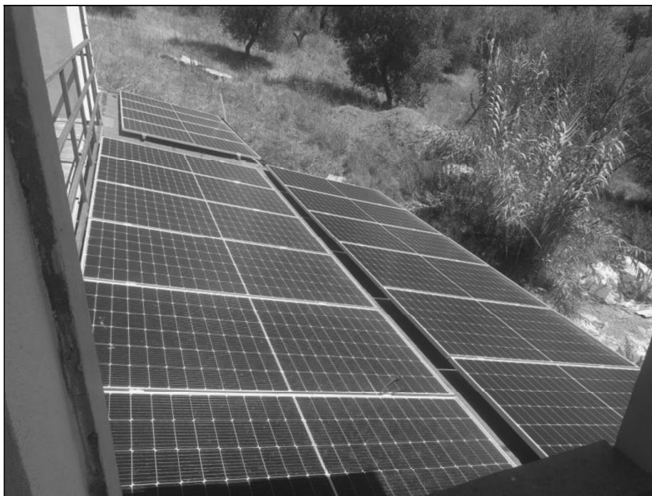
Vista pannelli fotovoltaici ubicati sulla copertura dell'ampliamento lato retro
