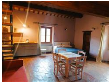
La sala ricreativa (con bagno, al P1): l'angolo cottura a sinistra e, in primo piano, la struttura del solaio in legno soprastante
