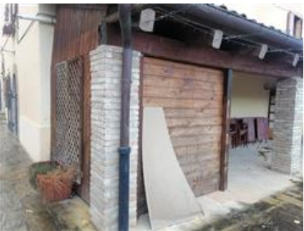
Part. 151, sub. 1 (nella tettoia o portico): vano tecnico realizzato con pannelli in legno per contenere/schermare caldaia e bollitore
