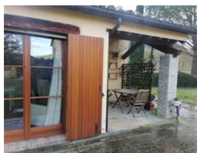
Sub. 2: la colonna d'angolo in mattoni, non rappresentata nelle planimetrie, pur rispondente ad esigenze statiche elementari (errore grafico?)
