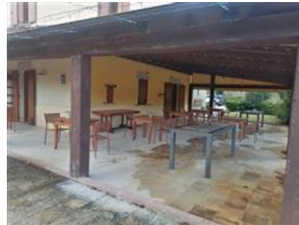
La pergola che copre una superficie di circa 82,60 mq (PGL, nelle consistenze)
