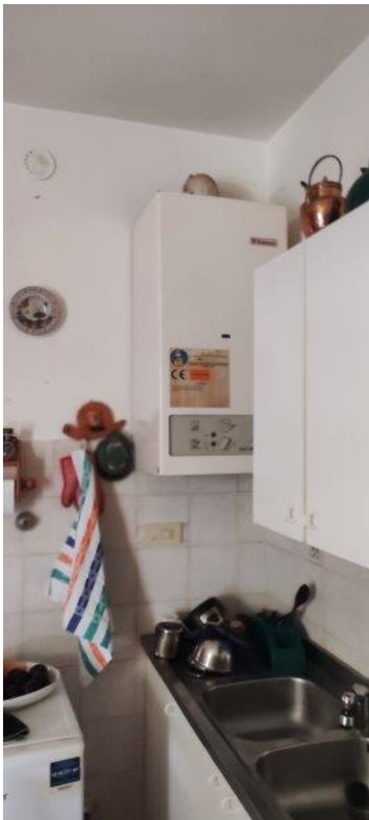
Figura 16 Caldaia Fabbri n°3
