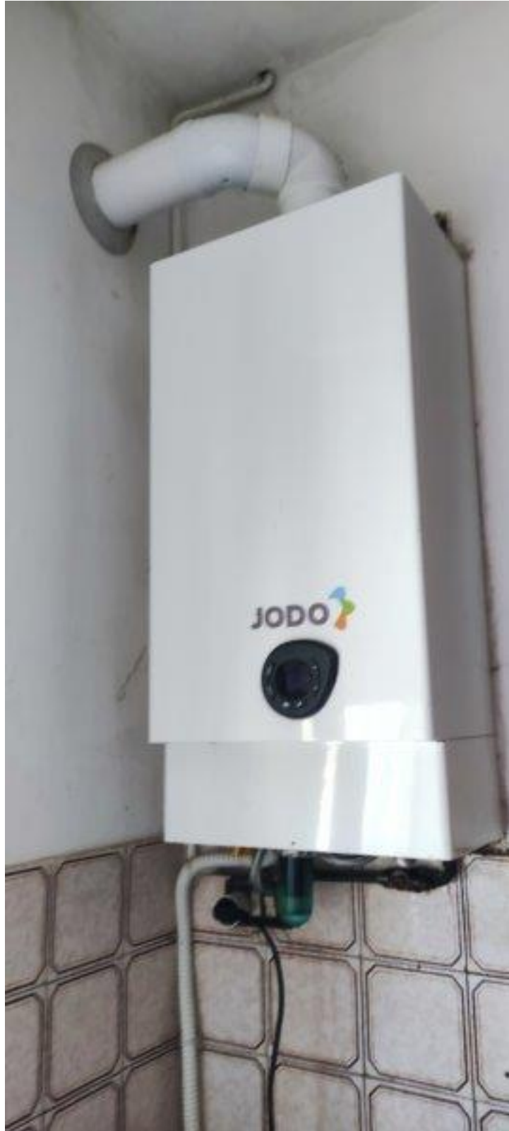
Figura 14 Caldaia Fabbriato n°4
