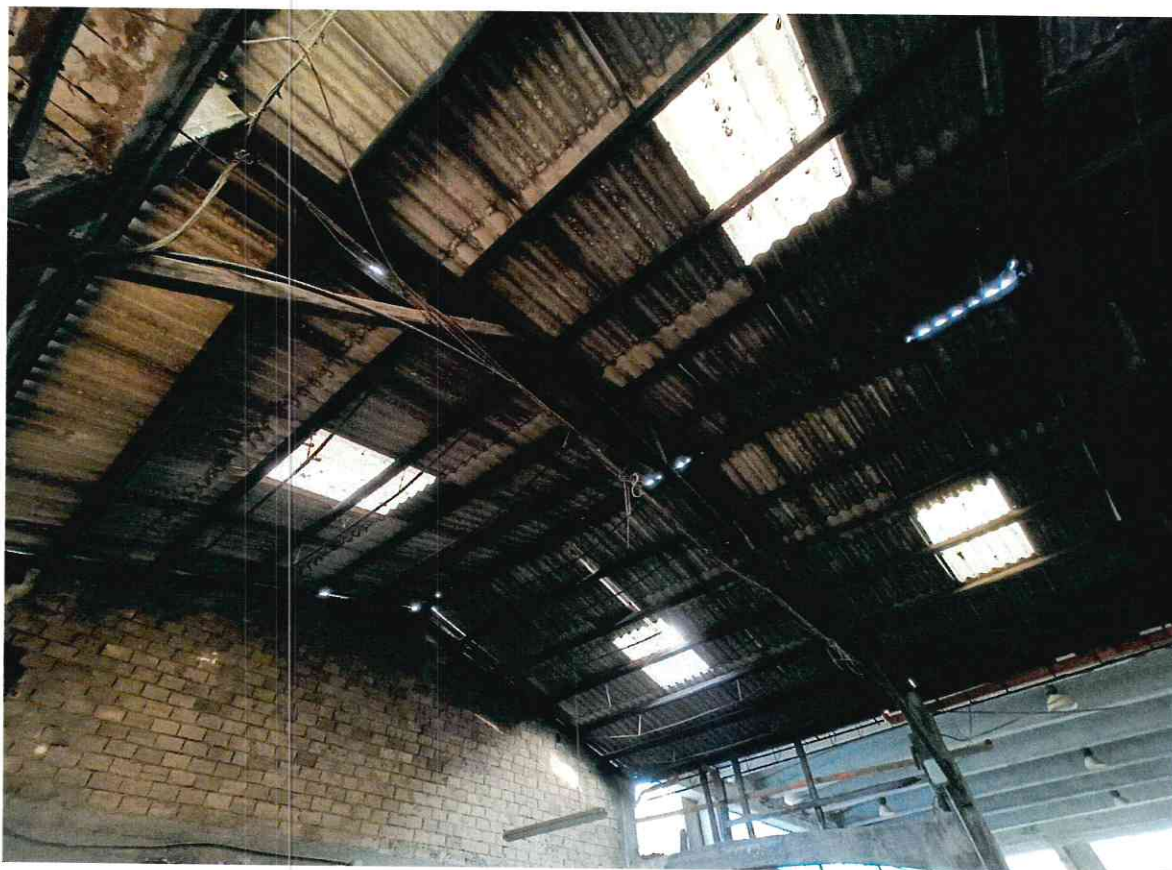
Foto 6 (onduline in amianto/eternit)
