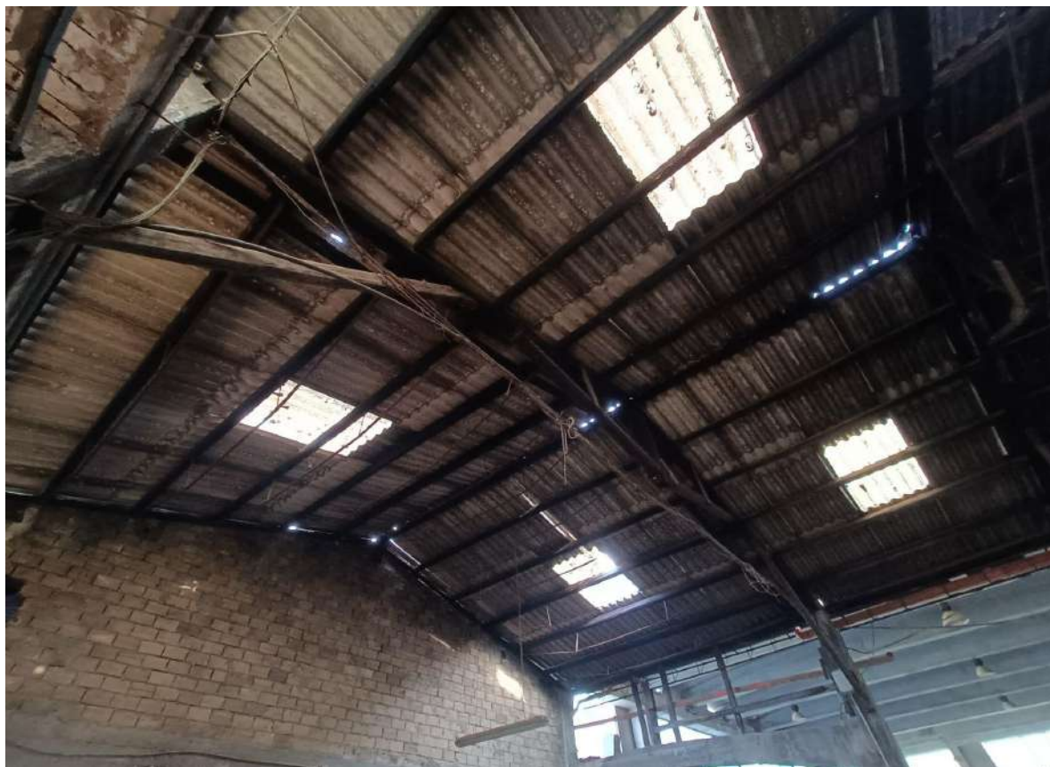
Foto 6 (onduline in amianto/eternit)
