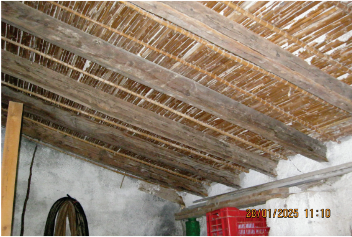
Foto 3: il magazzino della foto precedente visto dall'interno; si noti il tetto in canne e gesso
