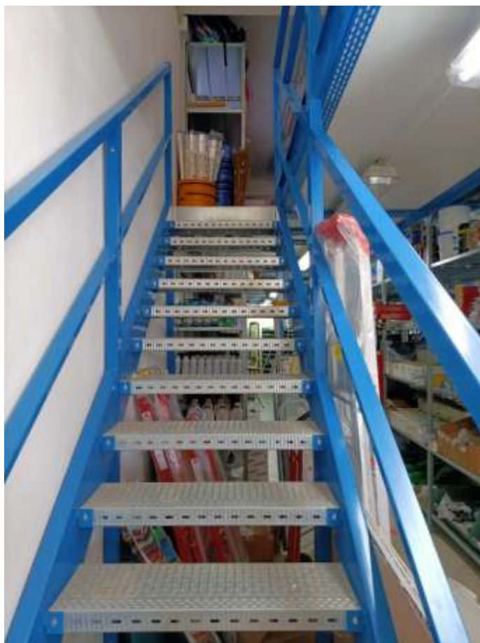
Scala metallica per l'accesso all'area soppalcata
