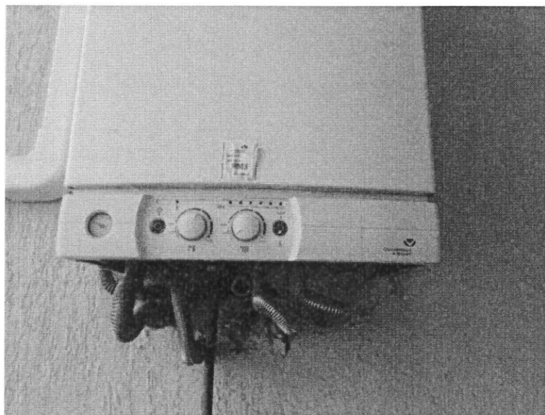
CALDAIA DELL'APPARTAMENTO FOGLIO 101 PART. 169 SUB.13
