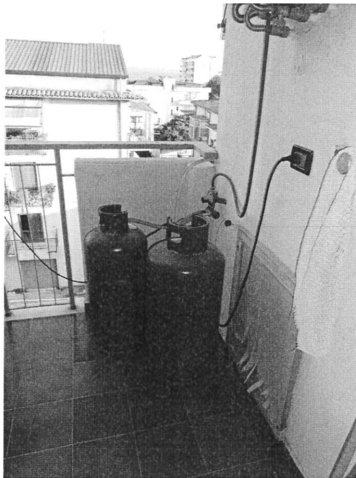
ALIMENTAZIONE CALDAIA DELL'APPARTAMENTO FOGLIO 101 PART. 169 SUB.13
