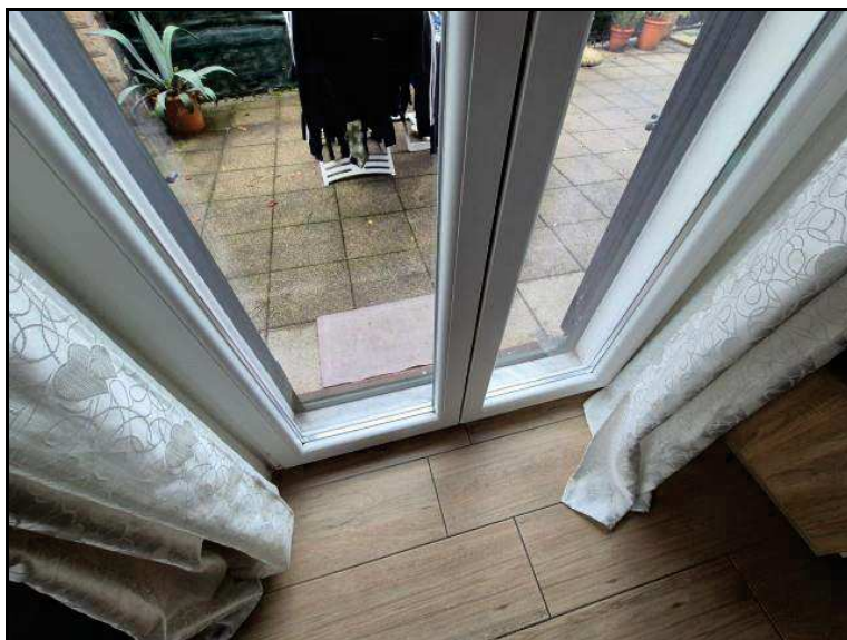
FOTO 25 U.I. MAPP. 4384 SUB. 502 VISTA PARTICOLARE SERRAMENTO ESTERNO (PORTA FINESTRA) DEL SOGGIORNO CHE COLLEGA AL TERRAZZO.
