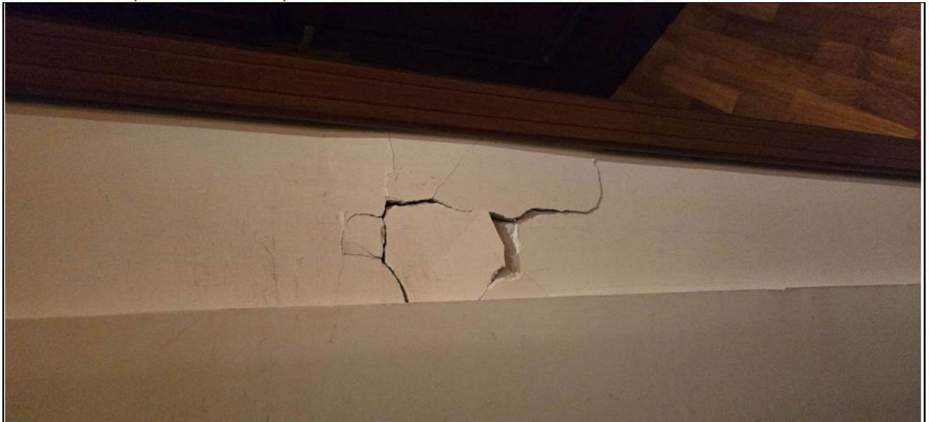
↓Foto10 Vista del corridoio dell'appartamento oggetto della procedura. Si npta la rottura nella parete in corrispondenza dell'accesso alla stanza da letto1
