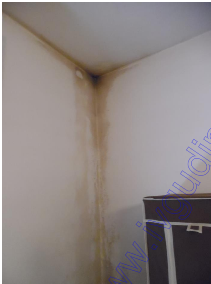
Infiltrazioni soggiorno – p.T
