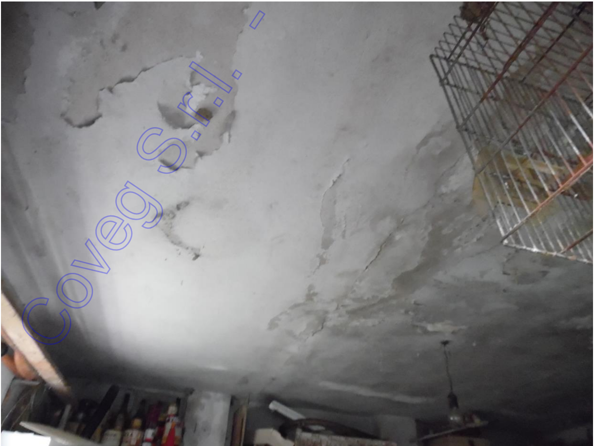
Infiltrazioni a soffitto fabbricato accessorio
