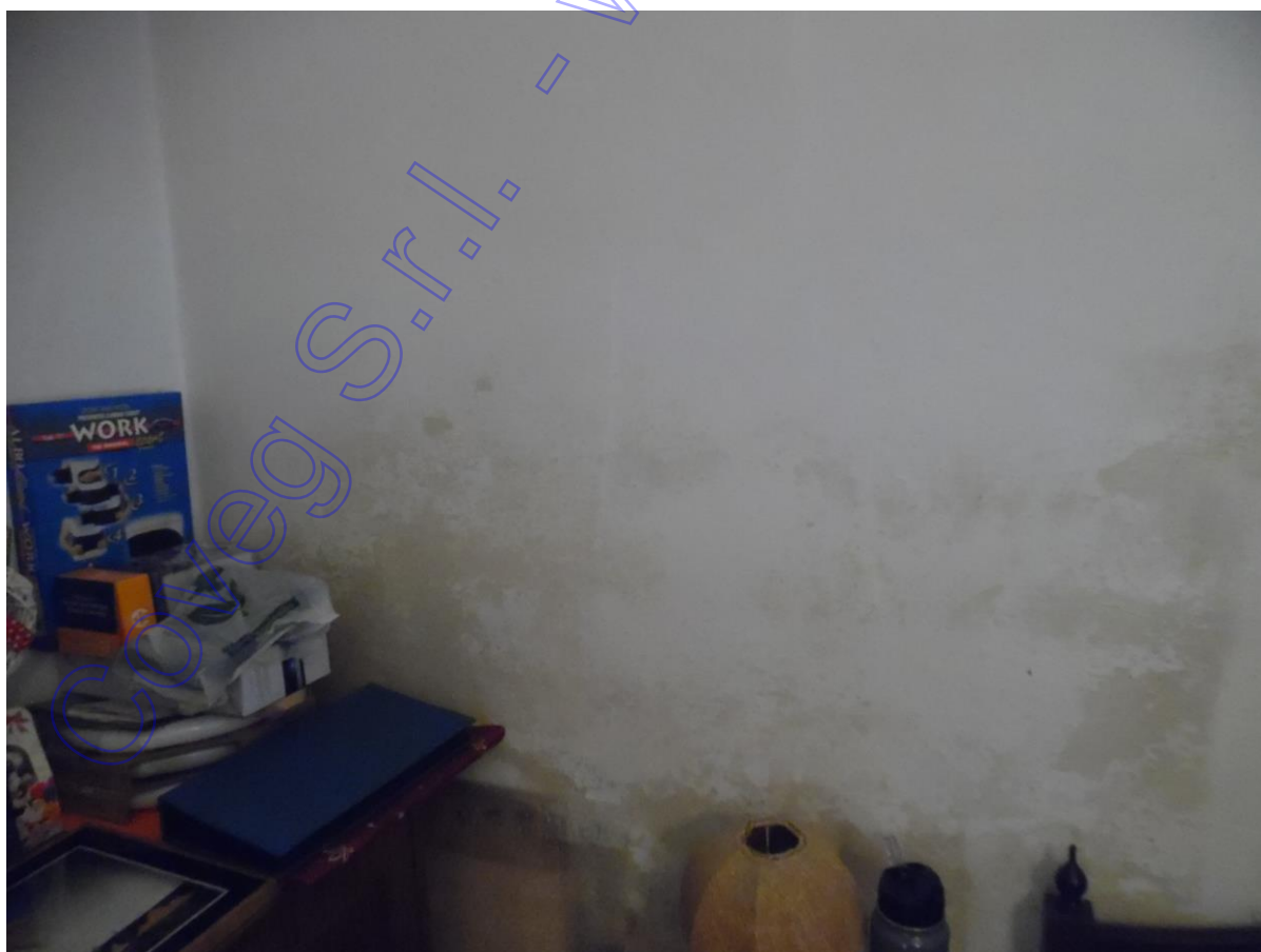
Umidità di risalita soggiorno – p.T
