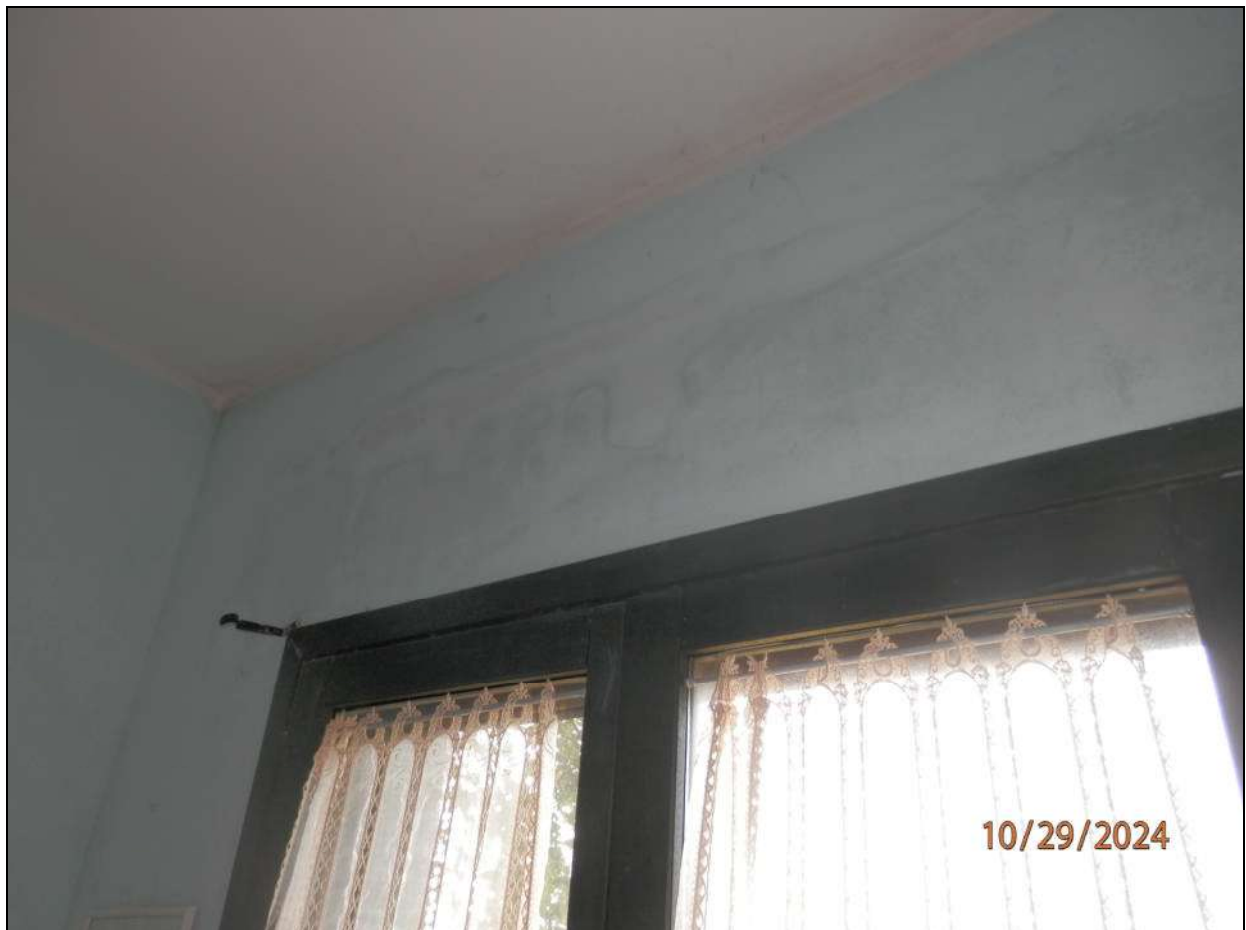
Fotografia N. 12 - particolare infiltrazioni dalla muratura - Piano Terra
