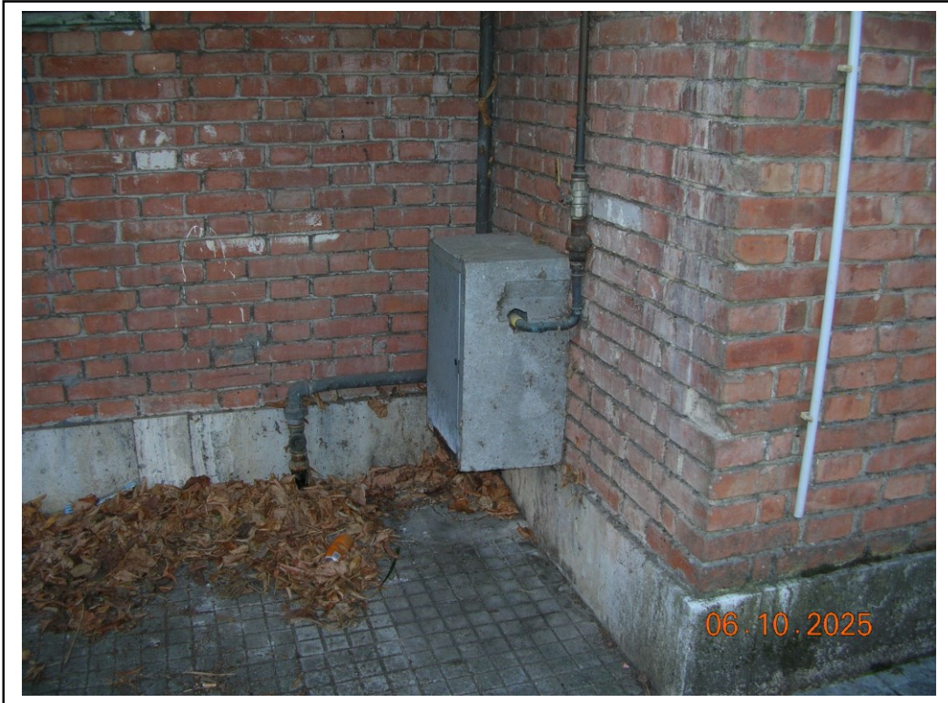
Alloggio contatore gas – metano posto sul retro del fabbricato
