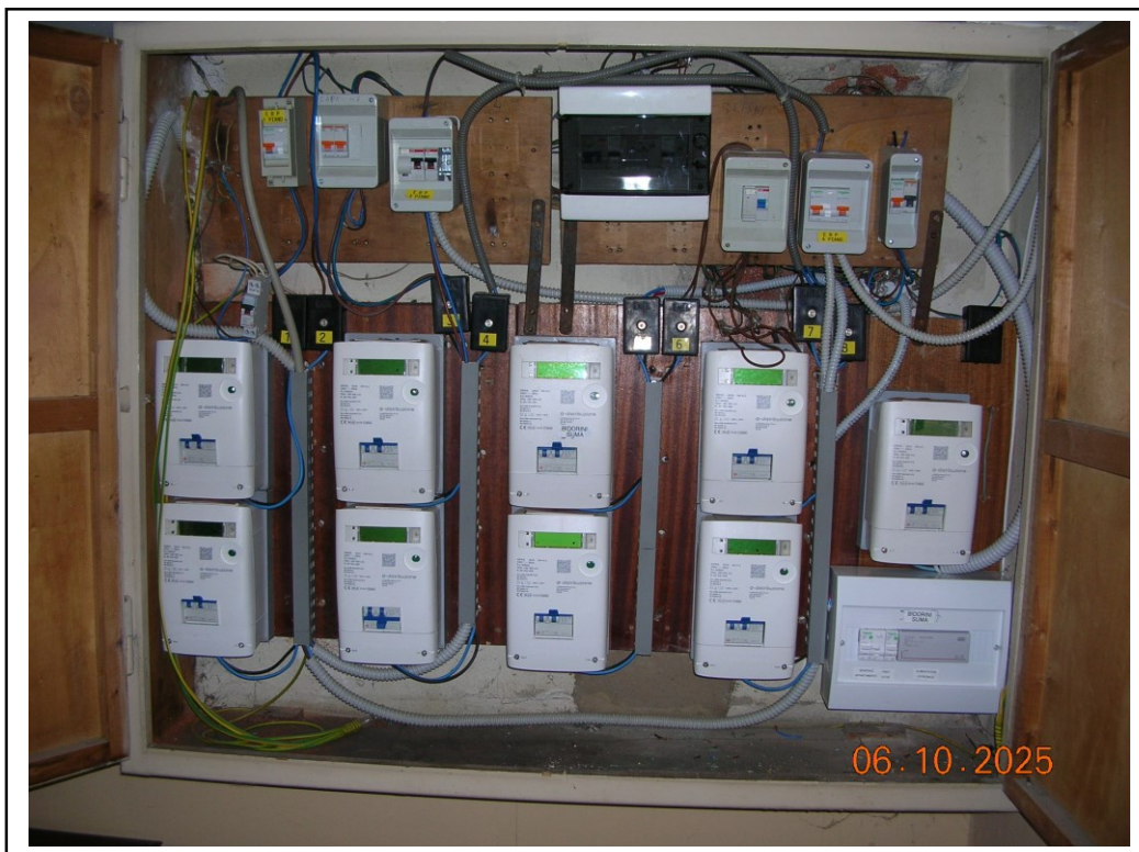
Vano contatori Enel posto nell'ingresso comune
