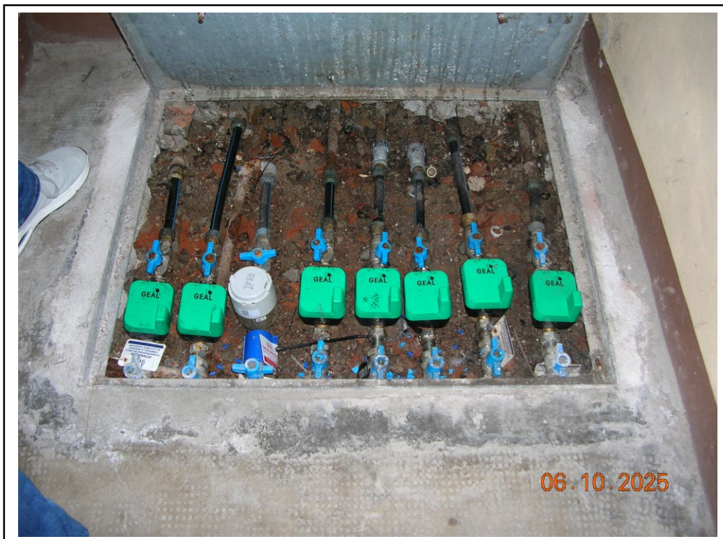
Vano contatori acqua adiacente alla scala comune d'accesso
