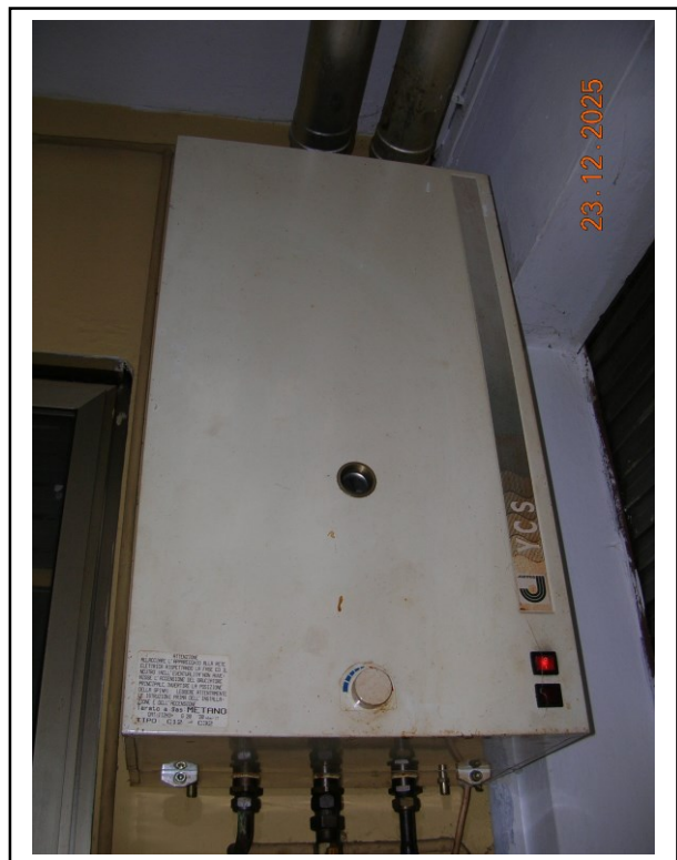
Caldaia, ubicata all'interno della veranda
