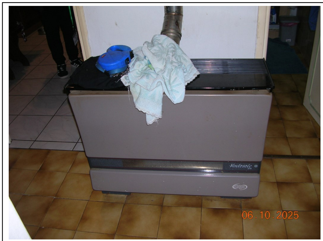
Stufa a metano che fornisce aria calda posta nel disimpegno
