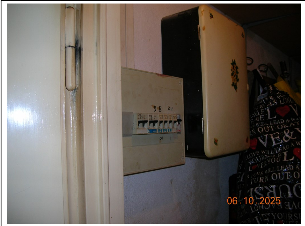
Quadro elettrico ubicato nel ripostiglio
