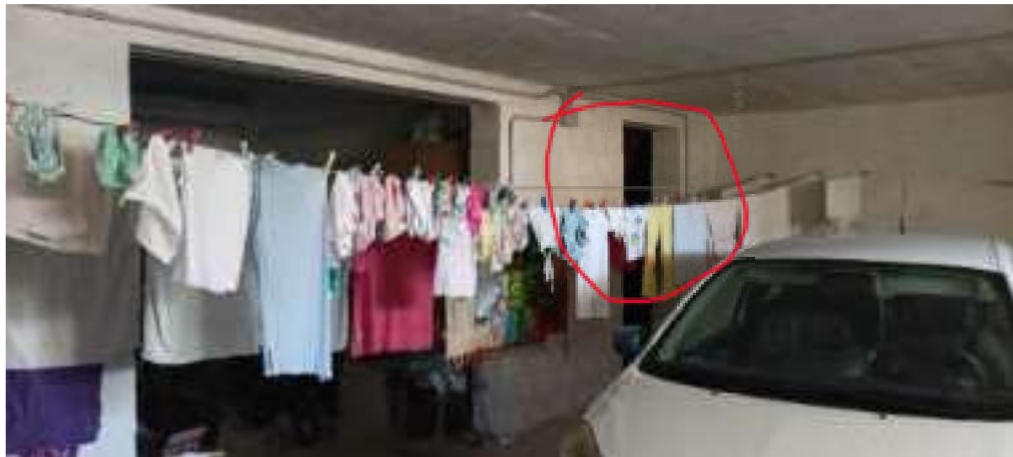
19.Varco e locale non autorizzato da chiudere
