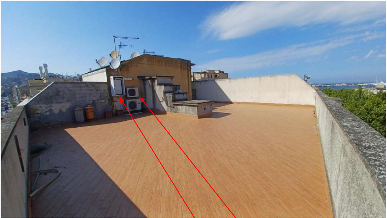
Terrazzo uso esclusivo – caldaia – motori split
