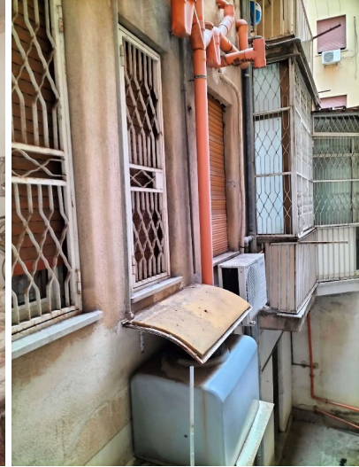
Foto 21 – Colonna di scarico sul pozzo
