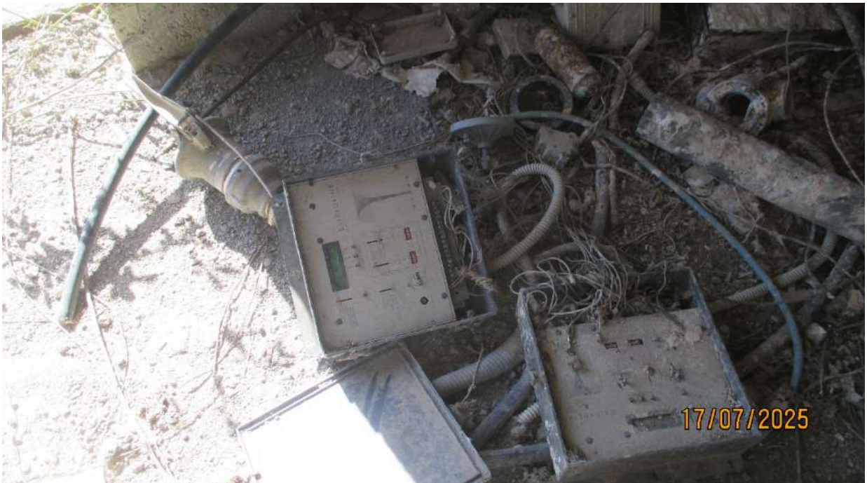
Figura 60. Impianti cabina pozzo divelti e vandalizzati
