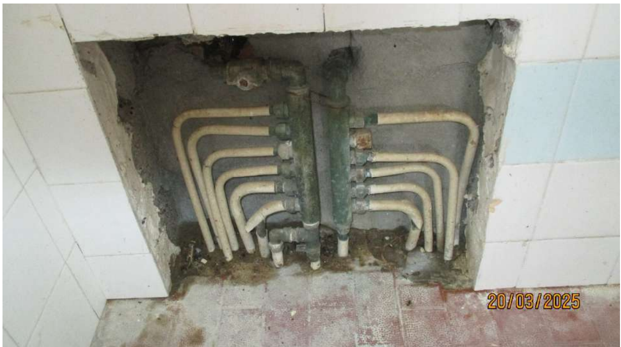
Figura 44. Particolare centralina idrica
