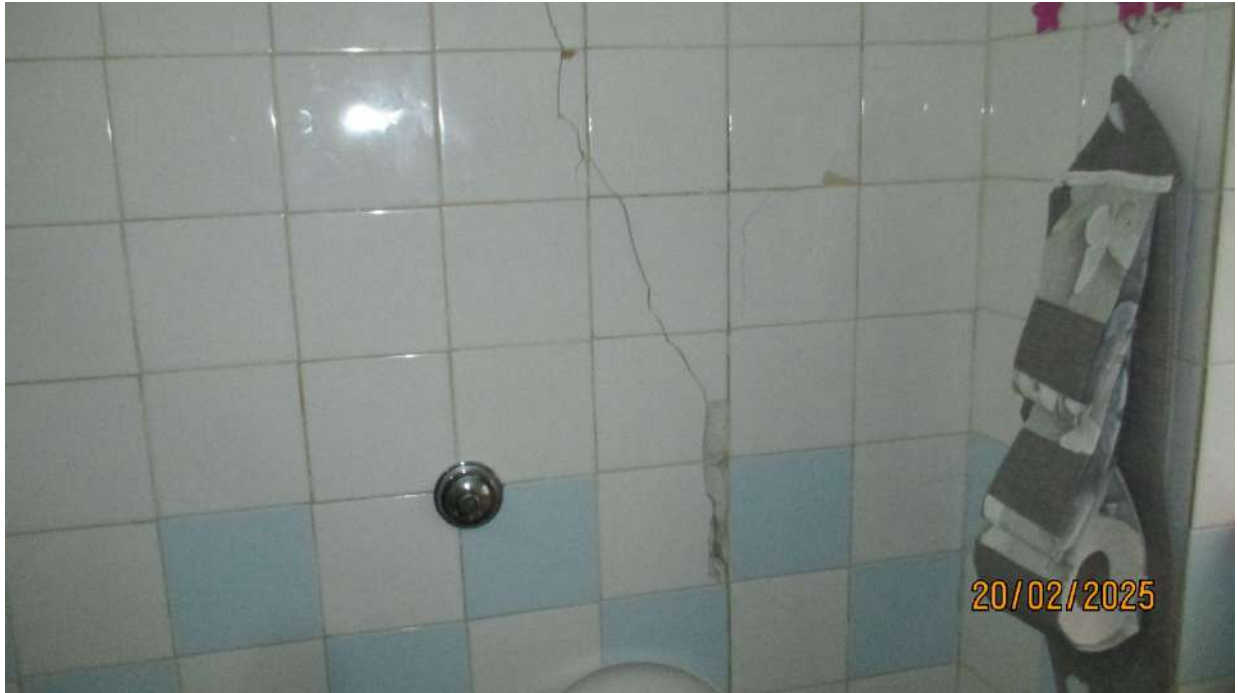
Figura 5. Particolare frattura del muro
