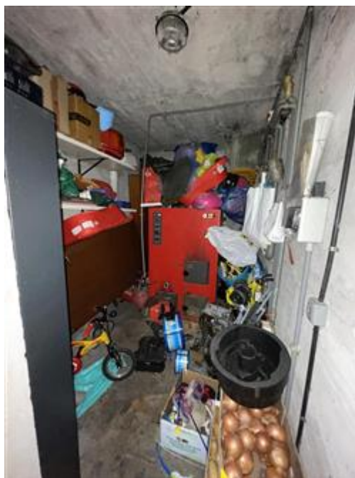
Centrale termica condivisa con altro sub.
