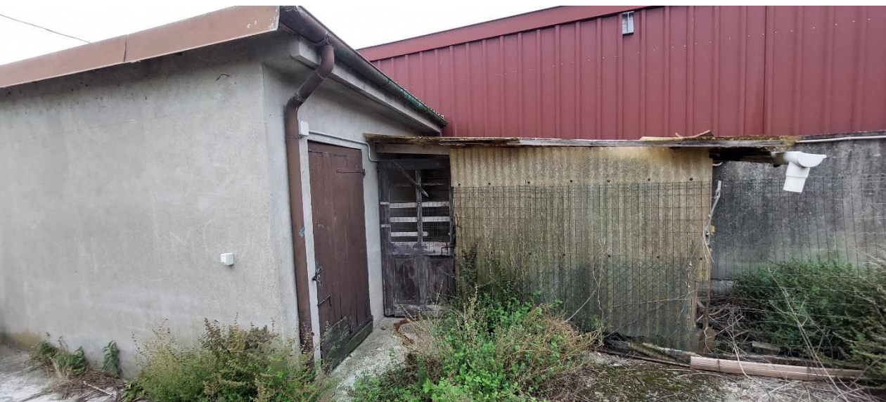
FOTO 3 – Struttura precaria addossata al garage da rimuovere
