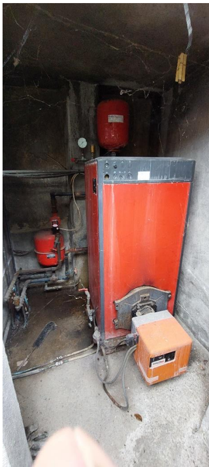
FOTO 19 – Bruciatore a gasolio
