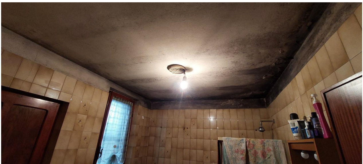
FOTO 15 – Soffitto bagno piano terreno
