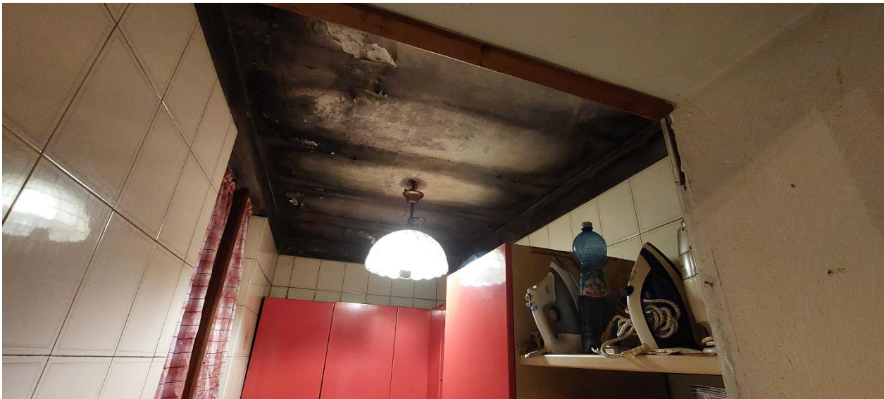
FOTO 10 – Soffitto cucinino piano terreno
