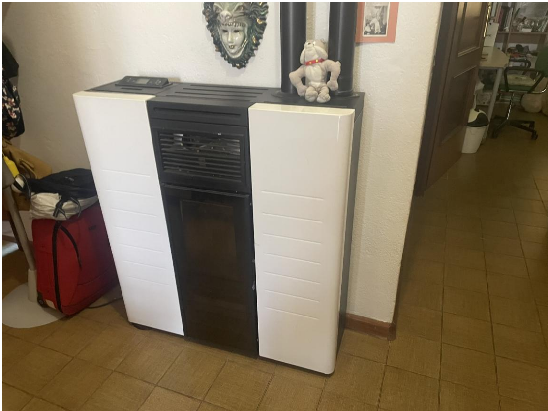
Vista della stufa a pellet a servizio delle camere
