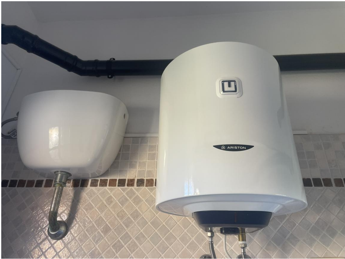
Dettaglio dello scaldabagno
