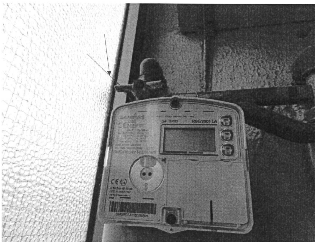
Foto 12 – Particolare de misuratore GAS con evidenza della sigillatura
