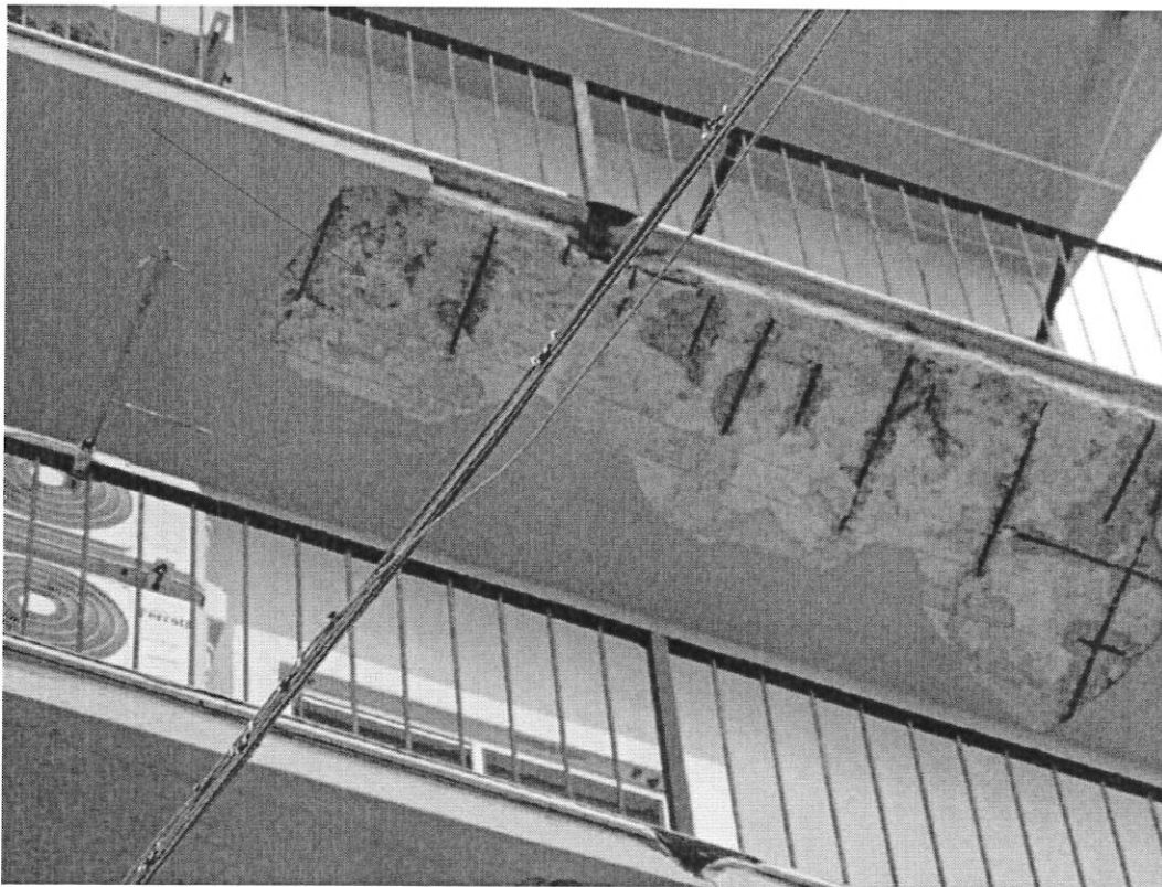
Foto 16 – Particolare sotto balcone e frontalino lato Via Bainsizza ammalorati
