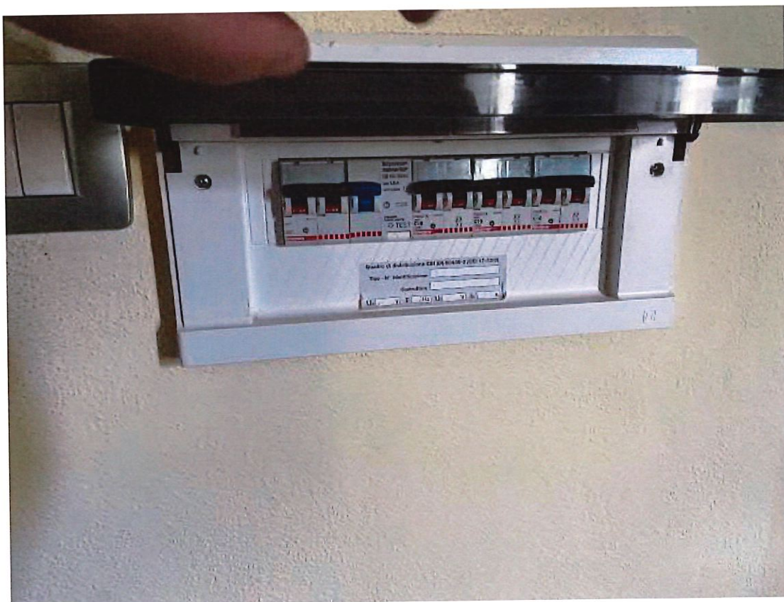
Foto 18 - Dettaglio Impianto Elettrico
