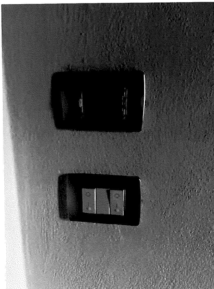
Foto 19 - Dettaglio Impianto Elettrico
