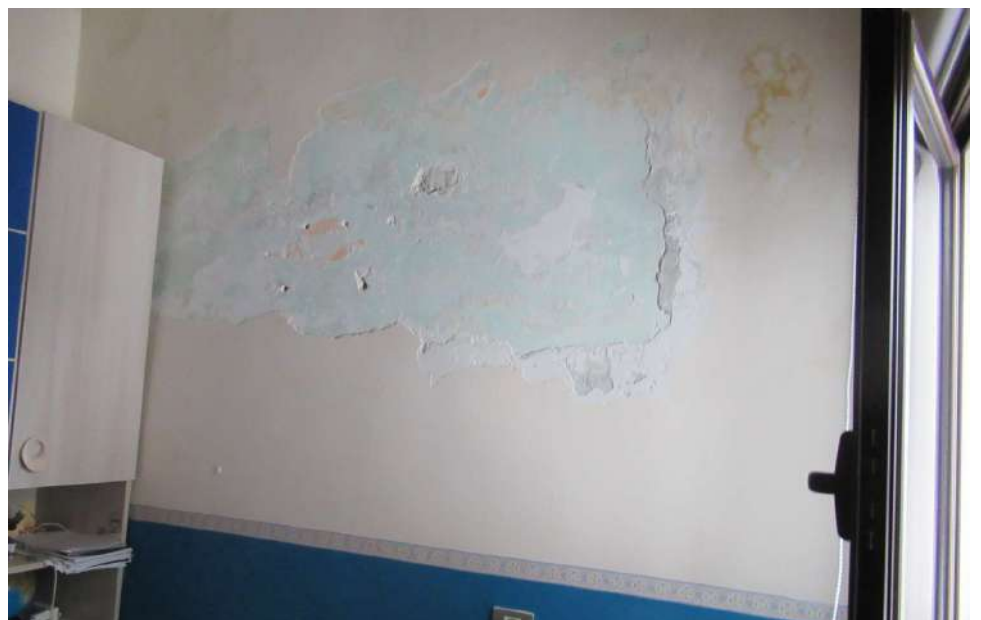
20 LETTO 3 Parete sud ammalorata
