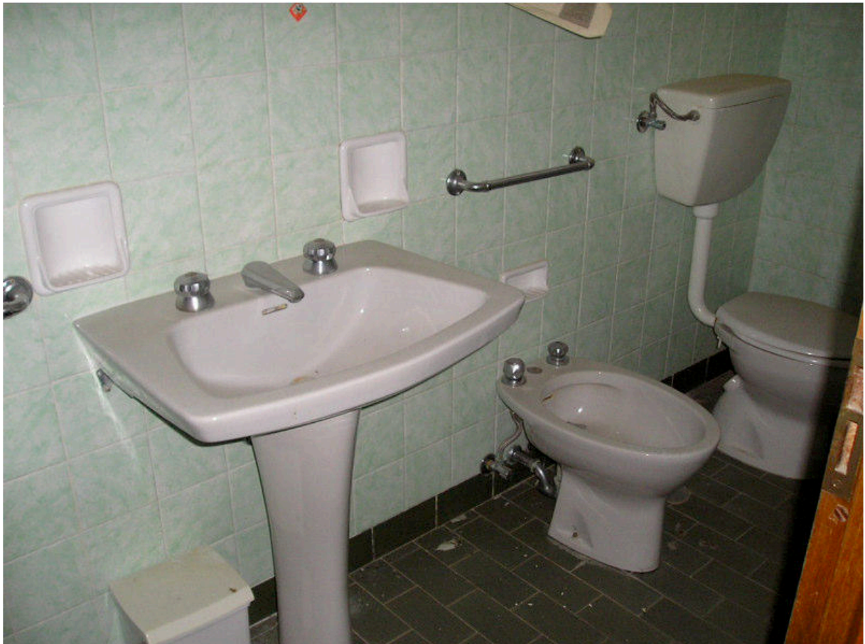
FOTOGRAFIA 58 - Piano Secondo / Servizio Igienico Tipo
