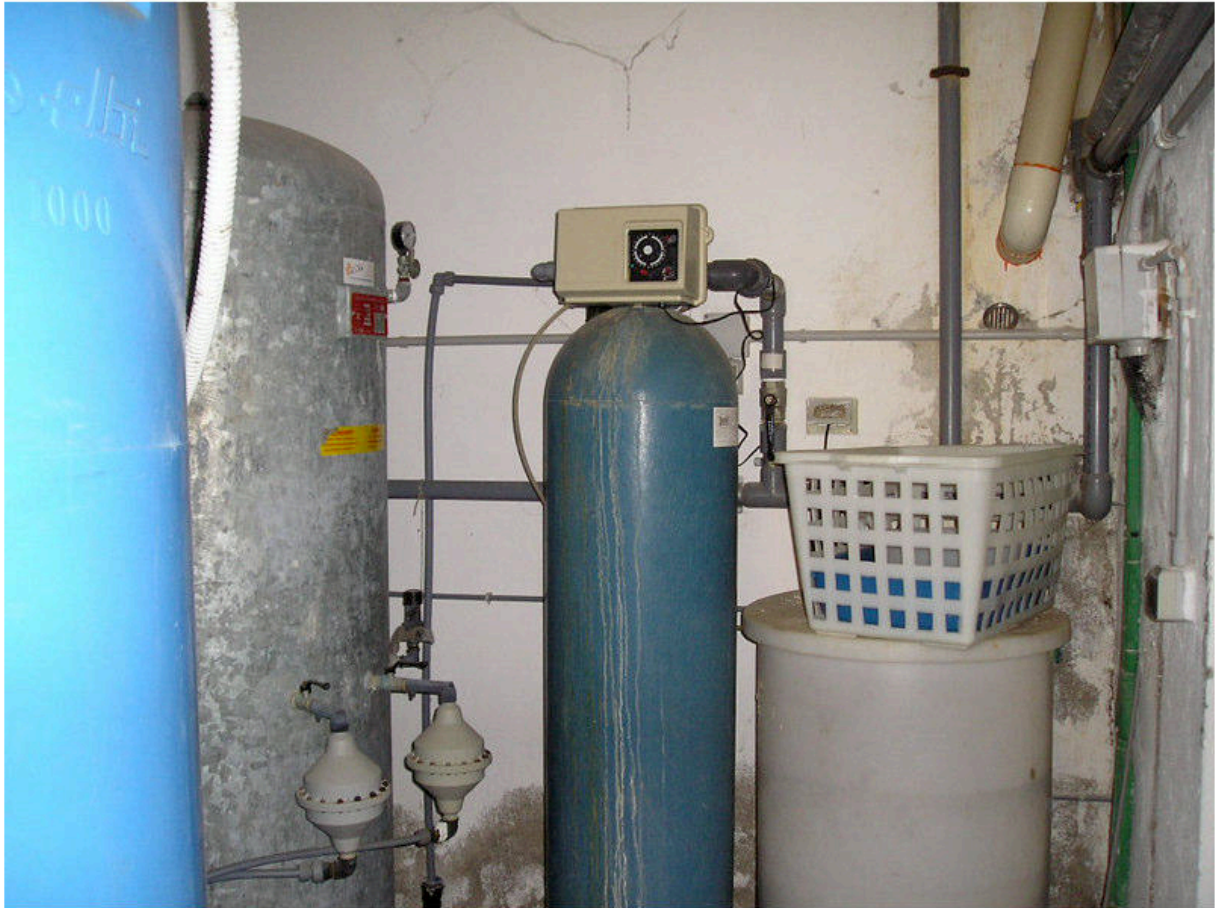
FOTOGRAFIA 45 - Piano Seminterrato / Vani Tecnologici
