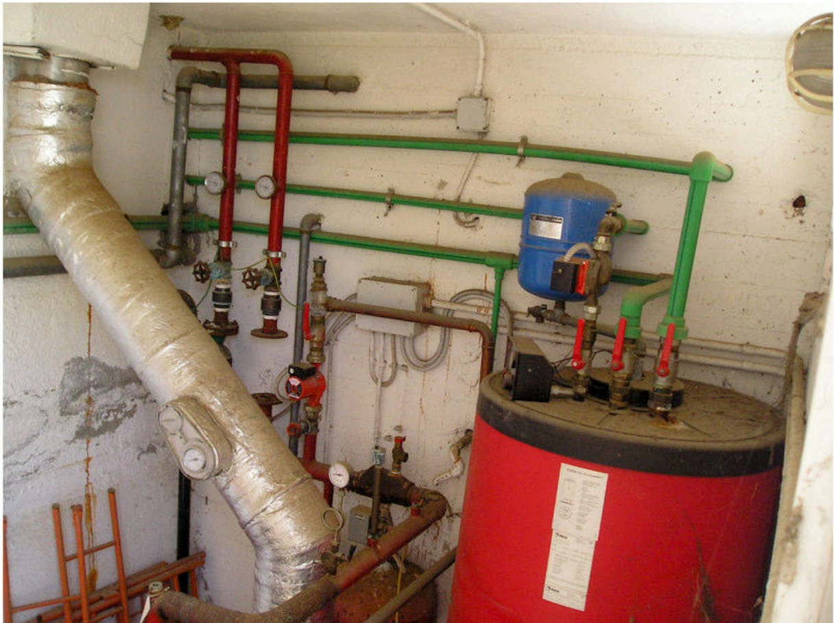
FOTOGRAFIA 48 - Piano Seminterrato / Centrale Termica
