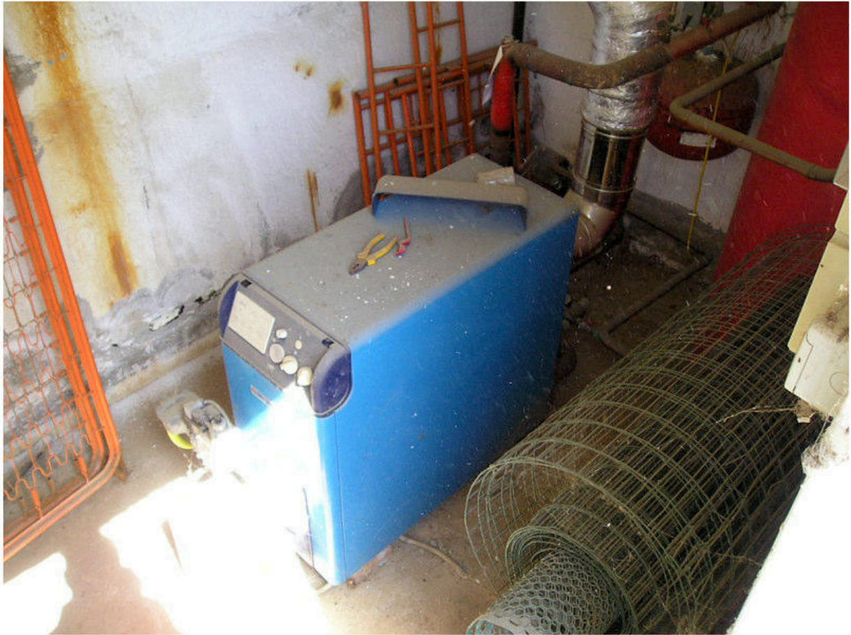
FOTOGRAFIA 47 - Piano Seminterrato / Centrale Termica
