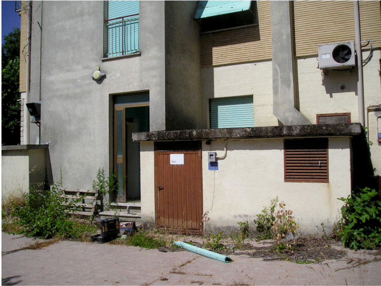
FOTOGRAFIA 15 - Esterno / Centrale Termica
