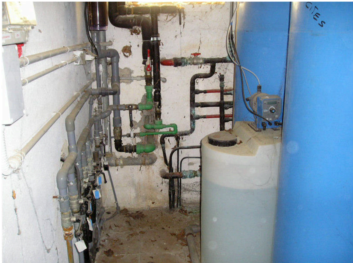
FOTOGRAFIA 46 - Piano Seminterrato / Vani Tecnologici
