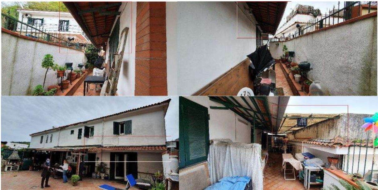
Fotografia 1 – Tre tettoie realizzate senza alcuna autorizzazione.
