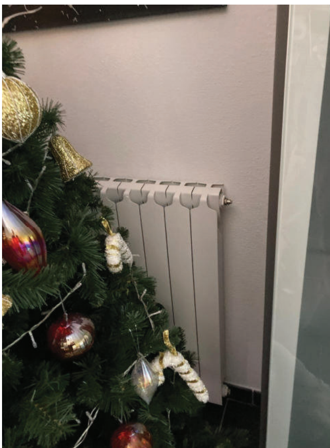
Foto n° 22 – Vista sul termosifone –
